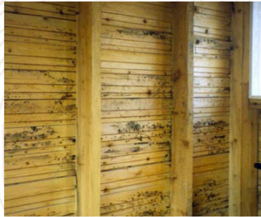
Kuva 4. Homesieni kehittyy herkästi ulkoilmaan rajoittuvilla pinnoilla. (RT 08-11286 2017.)
