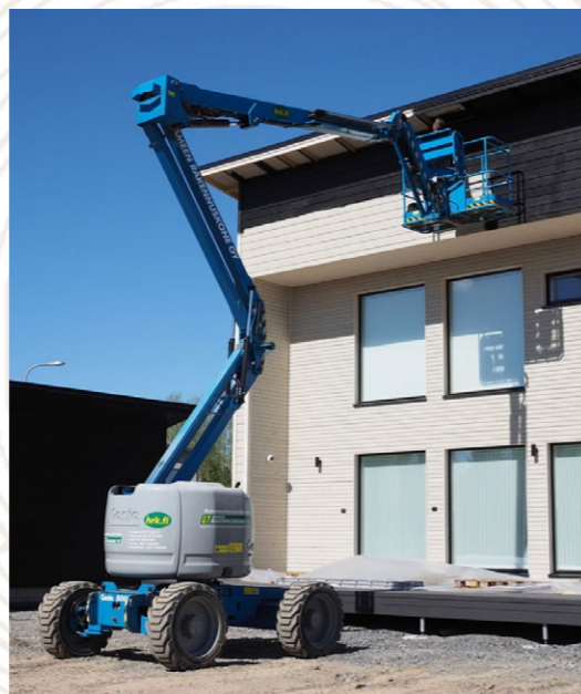
Kuva 29. Teollisella pohjamaalauksella tai täysin valmiiksi maalatuilla tuotteilla voidaan vähentää työmaalla tehtäviä maalaustöitä sekä varmistaa maalauksen hyvä laatu. (Rajala 2017.)
