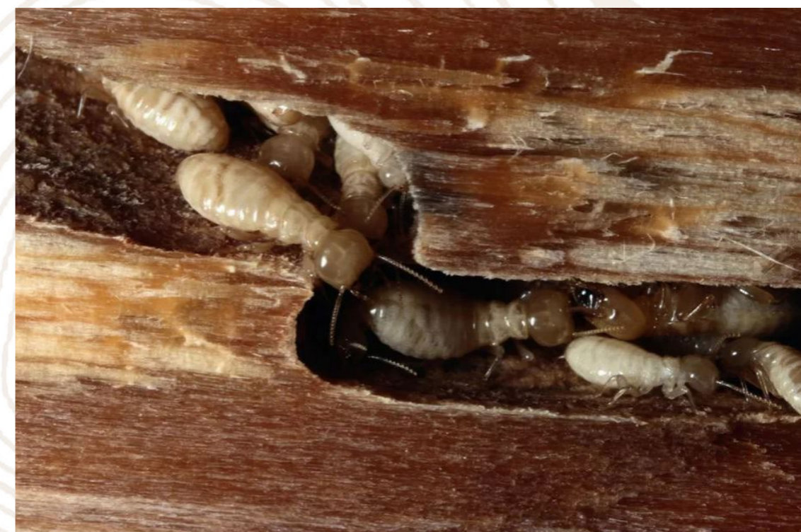
Kuva 30. Termiitit vahingoittavat puurakenteita syömällä puuhun laajoja luolaverkostoja. (Mullennix 2022.)
