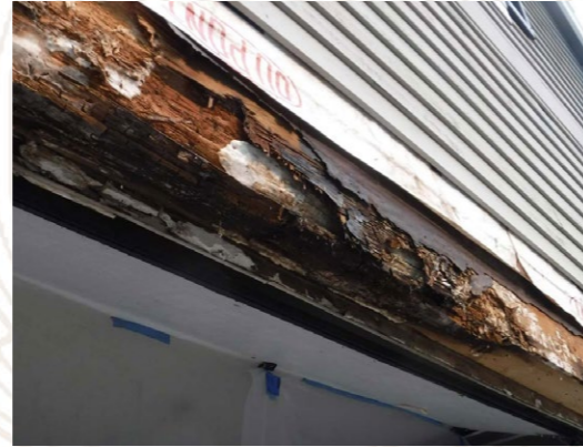
Kuva 3. Lahottajasienen aiheuttamia muutoksia rakennuksen kantavissa rakenteissa. (SFW Constructuion 2022.)
