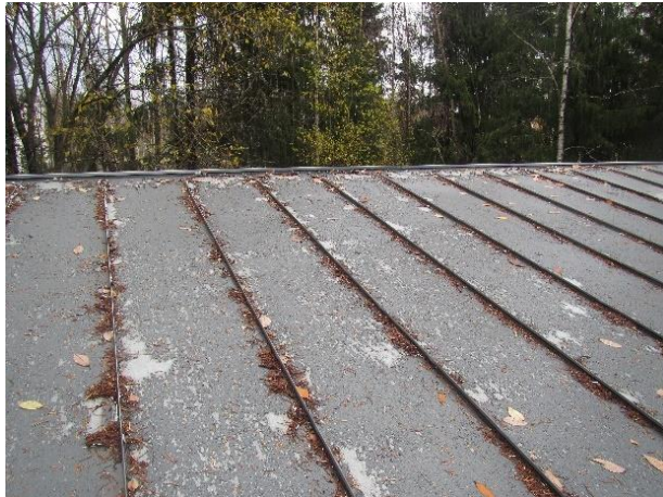
Kuva 36: Peltikaton maalipinta lohkeilee
