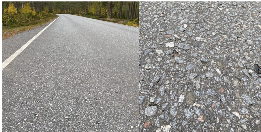
Kuva 15. Kohteessa 1 havaittu purkauma.
