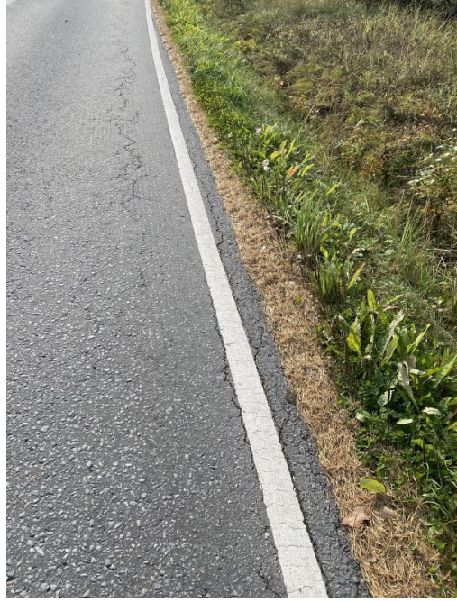
Kuva 23. Kohteessa 2 havaittuja pituussuuntaisia halkeamia.
