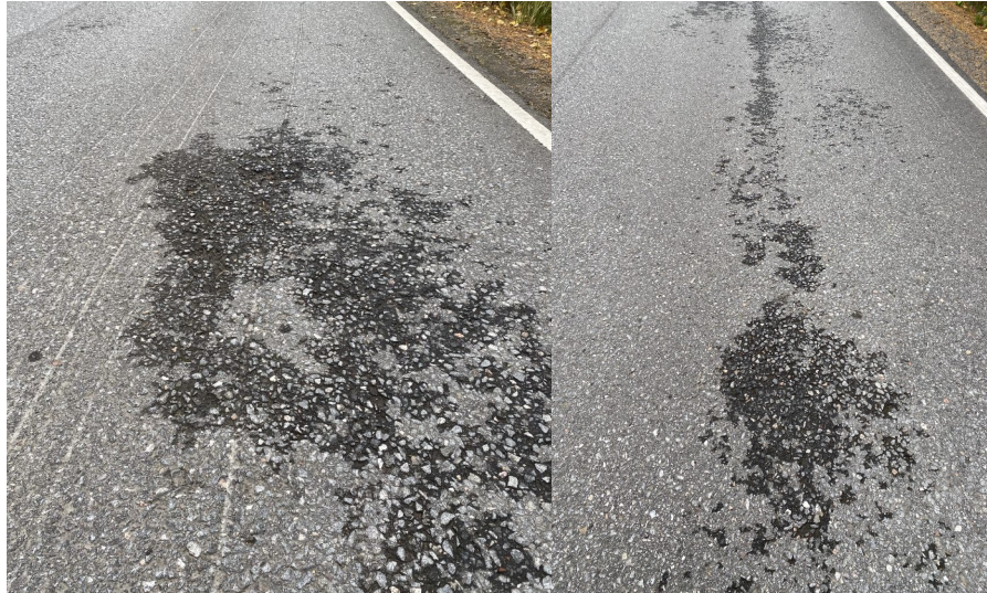
Kuva 16. Kohteessa 1 havaittuja purkaumia.
