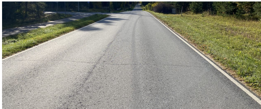
Kuva 24. Kohteessa 2 havaittu poikkisuuntainen halkeama.
