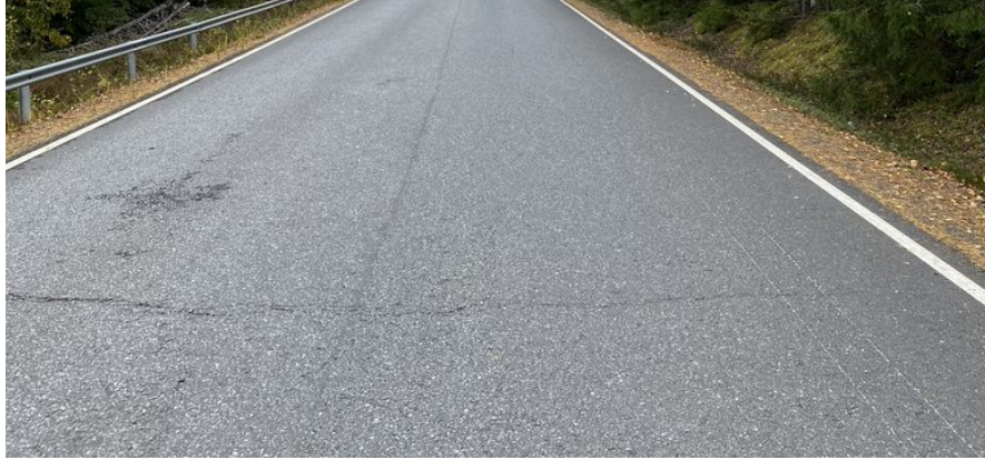
Kuva 21. Kohteessa 1 havaittu poikkisuuntainen halkeama.
