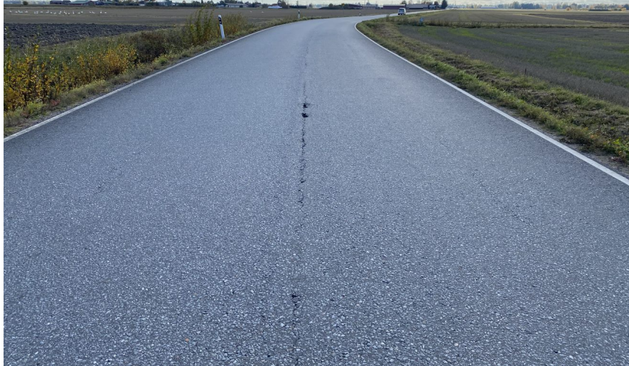
Kuva 26. Kohteessa 2 havaittu avoin keskisauma.
