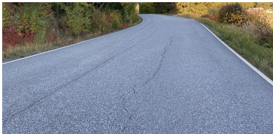
Kuva 25. Kohteessa 3 havaittuja pituussuuntaisia halkeamia.
