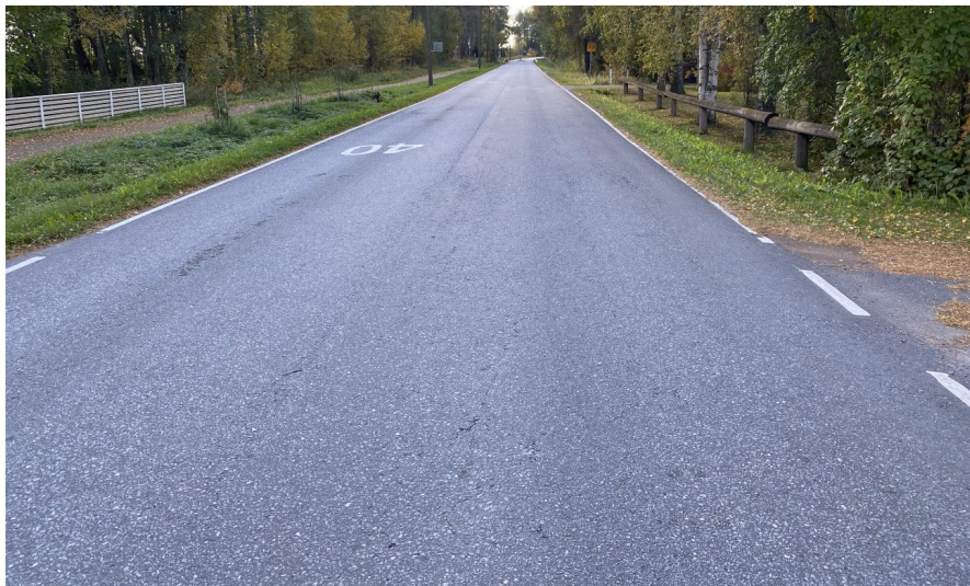
Kuva 22. Kohteessa 2 havaittua verkkohalkeamaa.
