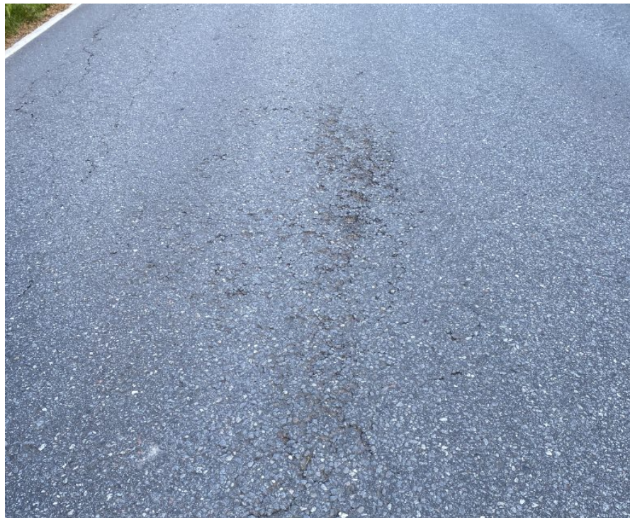
Kuva 17. Kohteessa 2 havaittu purkauma.
