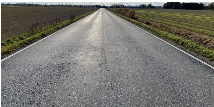
Kuva 19. Kohteessa 2 havaittua sideaineen pintaan nousua.
