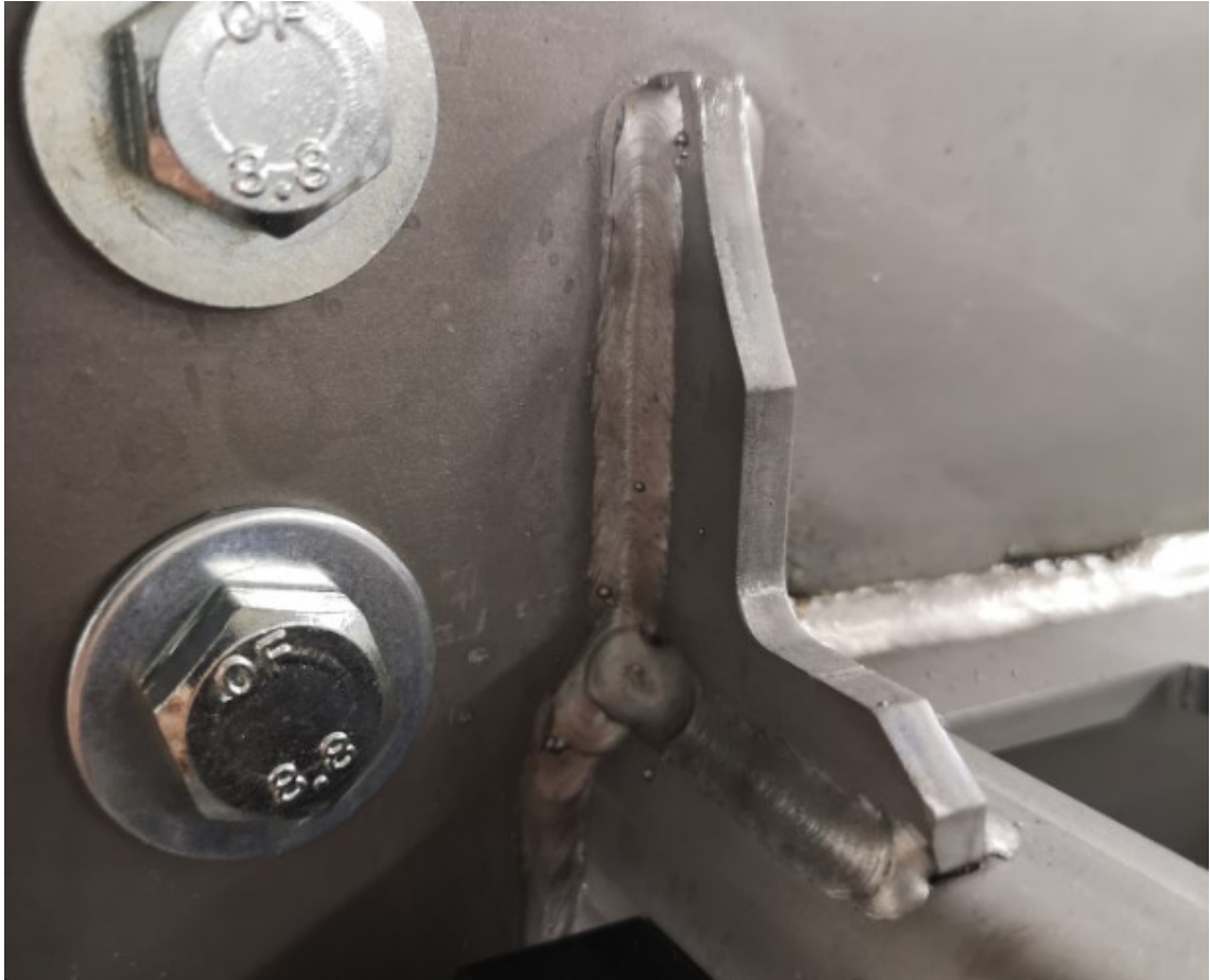
Kuva 30. Jännityskeskittymäalue hitsatun tukilevyn nurkkapyörityksessä.
