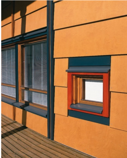
Kuva 12. Vaneri julkisivuverhouksessa (RT 82-10829 2004)
