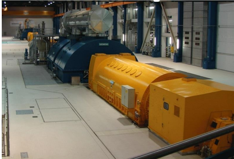
Kuva 9. Höryturbiinigeneraattori Schwarze Pumpe -voimalaitoksen turbiinihallissa [9]. Saksan Brandenburgin osavaltiossa sijaitseva Schwarze Pumpe toimii hiilivoimalla ja sillä on kaksi 800 MW yksikköä. [10]
