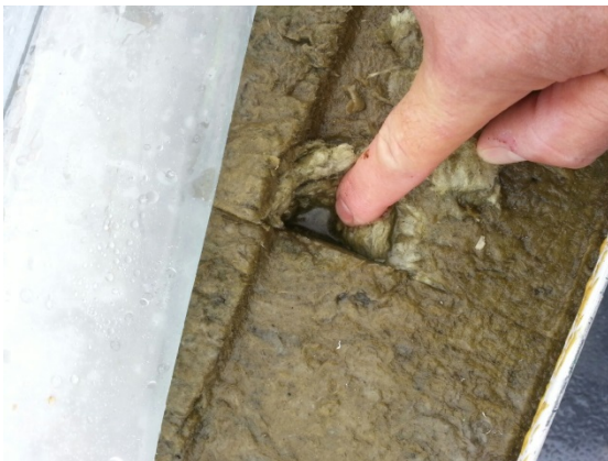
Kuva 2. Sateen kastelema elementin yläreuna.
