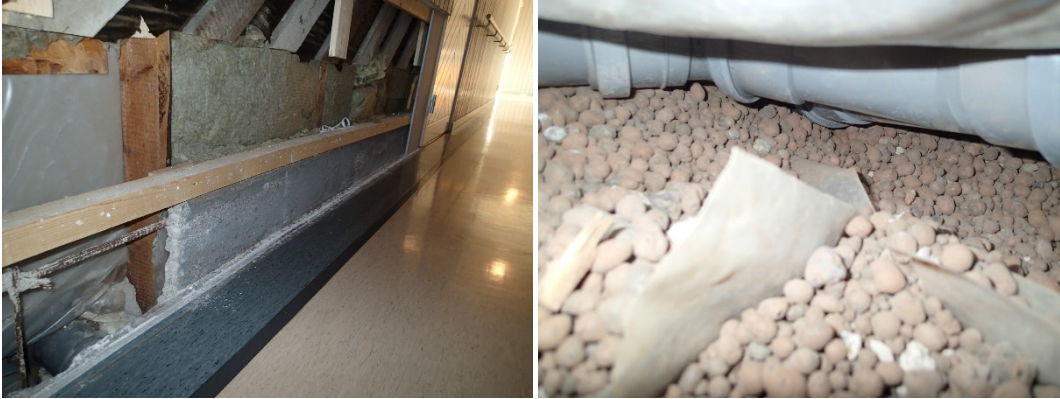
Kuvat 1 ja 2. Vanhaa valesokkelirakennetta entisen ulkoseinän kohdalla. Seinärakenteen kautta todettiin suora ilmayhteys alapohjan leca-sorakerrokseen.
