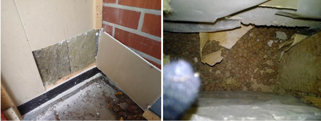
Kuvat 7 ja 8. Rakenneavauksessa todettiin toisen palvelutalon ulkoseinän puurakenteen jatkuvan alapohjan alle ja alajuoksun sijaitsevan noin 20 cm maanpinnan alapuolella.
