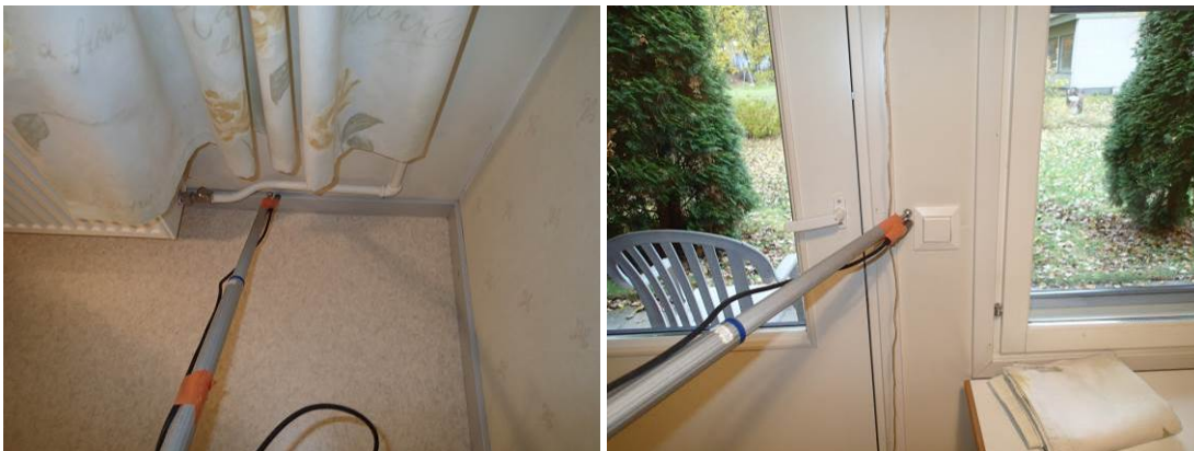
Kuvat 5 ja 6. palvelutalossa tehdyssä merkkiainekokeessa todettiin ilmaa virtaavan alapohjan alta huoneeseen alapohjan ja ulkoseinän liittymästä sekä ulkoseinän pistorasioiden ja ikkunaliittymien kautta.
