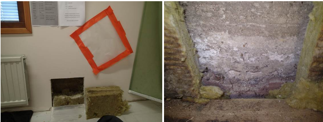
Kuvat 9 ja 10. Toisessa palvelutalossa ulkoseinän rakenneavauksessa havaittiin kalkkihärmää valesokkelin taustapinnassa.
