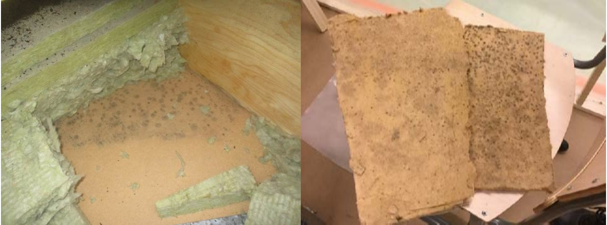
Kuva 5. Termopol-levyn takapinnalla esiintyy mikrobikasvustoihin viittaavia tummentumia ja paikoin levyssä esiintyy mikrobivaurioita.
