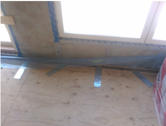
Kuva 4. Höyrynsulun ehjyys välipohjien kohdalla on haasteellista ulkoseinäelementtien kiinnikkeiden vuoksi. Höyrynsulku on otettava huomioon sekä rakenteiden liitosten suunnittelussa, että työjärjestyksiä suunniteltaessa.
