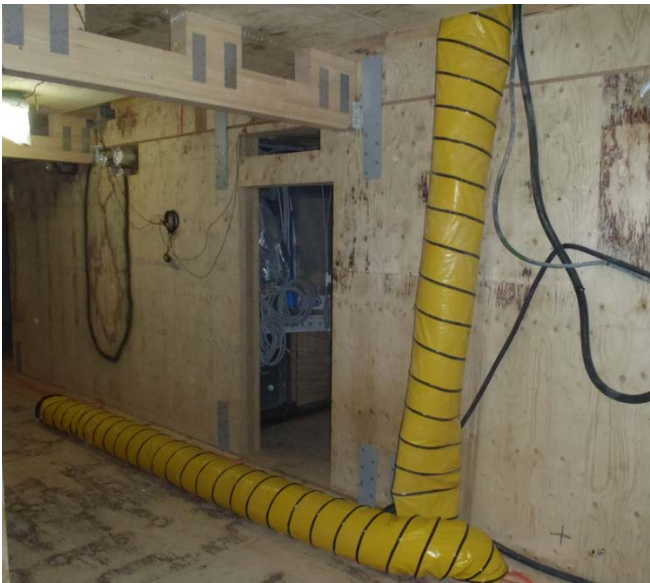
Kuva 3. Riittäväällä lämmityksellä ja ilmanvaihdolla nopeutetaan rakenteiden kuivumista. Ilmanvaihdon riittävyys varmistetaan ilman suhteellisen kosteuden mittaamisella, jonka tulisi olla 40-60% välillä.
