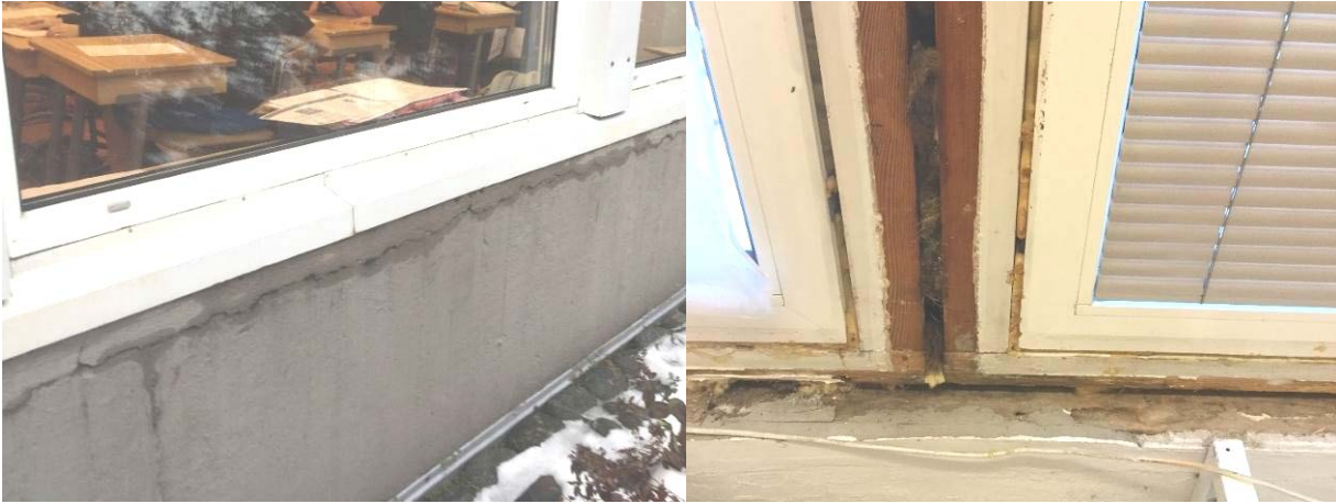
Kuva 1. Ikkunoiden vesipellitykset ovat vuotaneet ja betonisokkelissa esiintyy halkeamia, minkä johdosta ikkunan alla olevissa kiinnityspiissa esiintyy lahovaurioita. Peruskorjauksen yhteydessä on uudet ikkunat asennettu alkuperäisten karmien sisään. Alkuperäisten karmien tilkiväleissä on pellavarivettä, jonka PAH-yhdisteiden pitoisuudet ovat korkeita. PAH-yhdisteiden hajua on imeytynyt alkuperäisiin puusiin.
