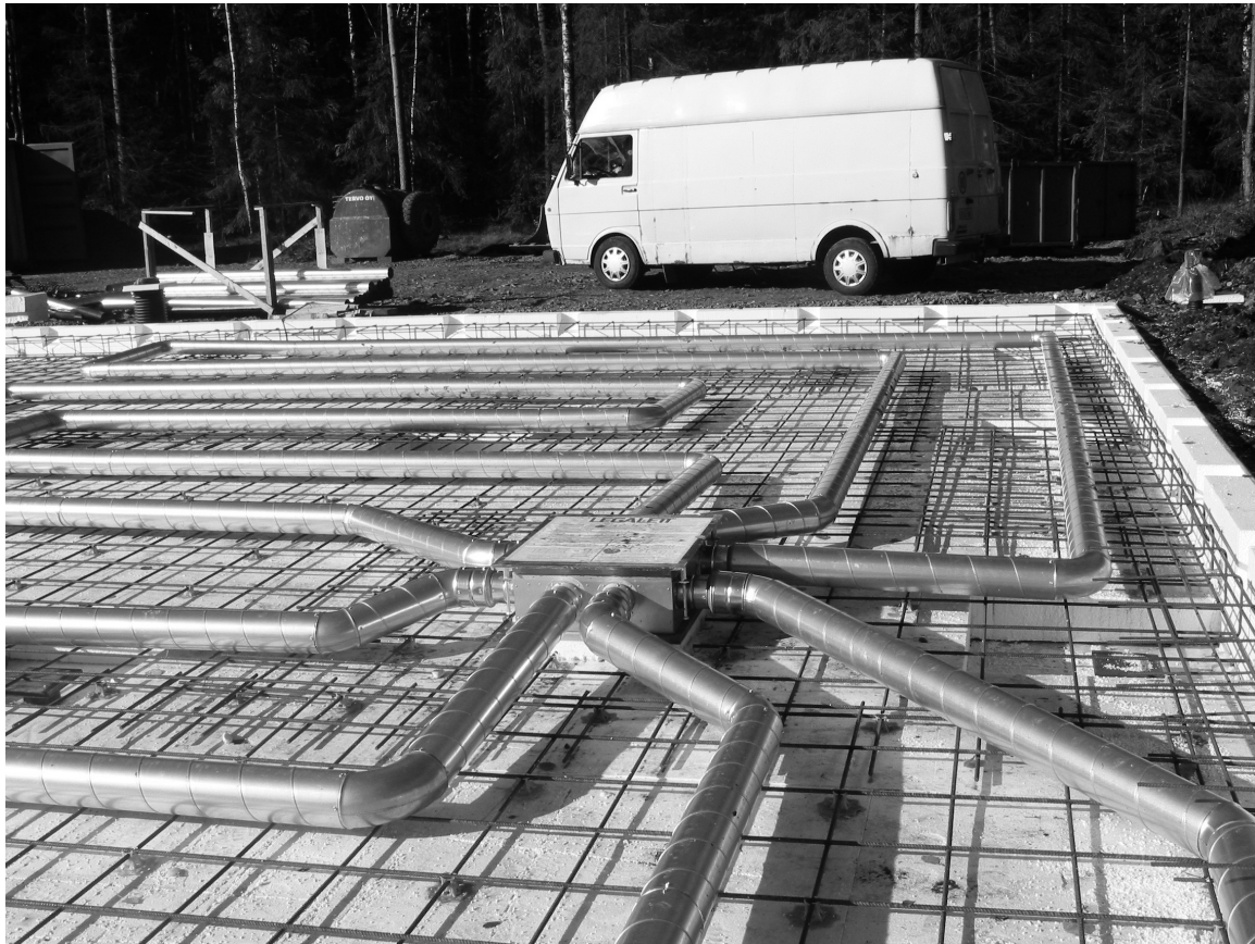
Kuva 5.24 Kohteen D pohjalaatan lämmitysputkistoa.
