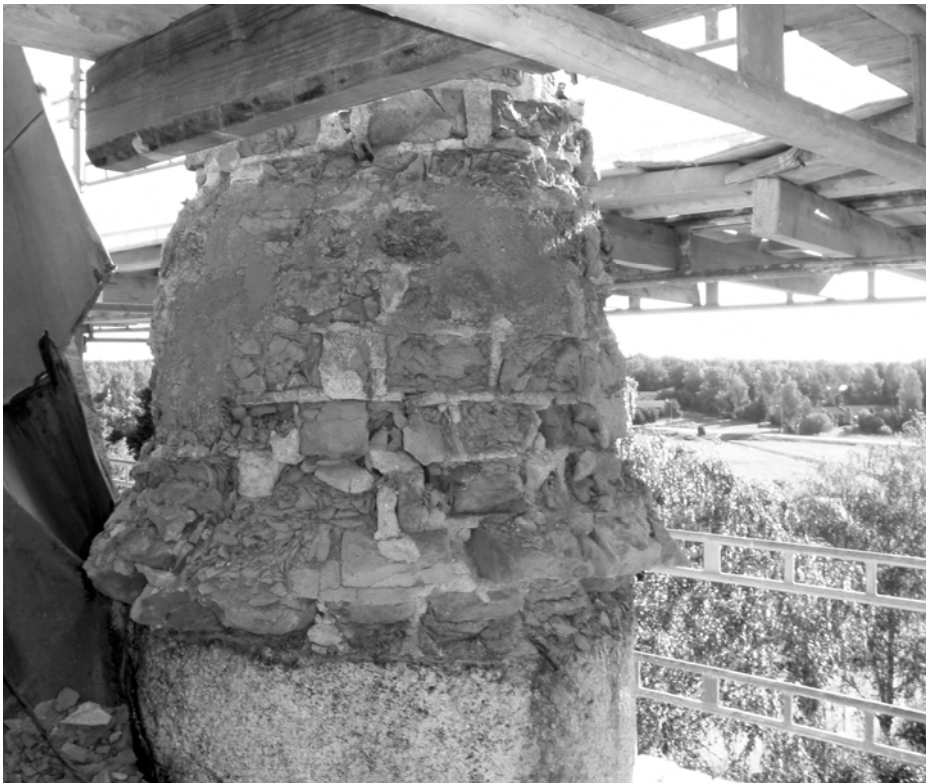
Kuva 1. Kuparipellillä katetun noin kaksi metriä korkean pikkutornin sisäpuolen täytemuuraus on kokonaan rapautunut 100 vuoden aikana. Korjauksena uusi muurattu runko ja korjattu alkuperäinen kuparipeltihuppu. Rakennusosa on periaatteessa hyödytön, mutta se on oleellinen osa kohteen arkkitehtuuria ja siksi korjattava.
