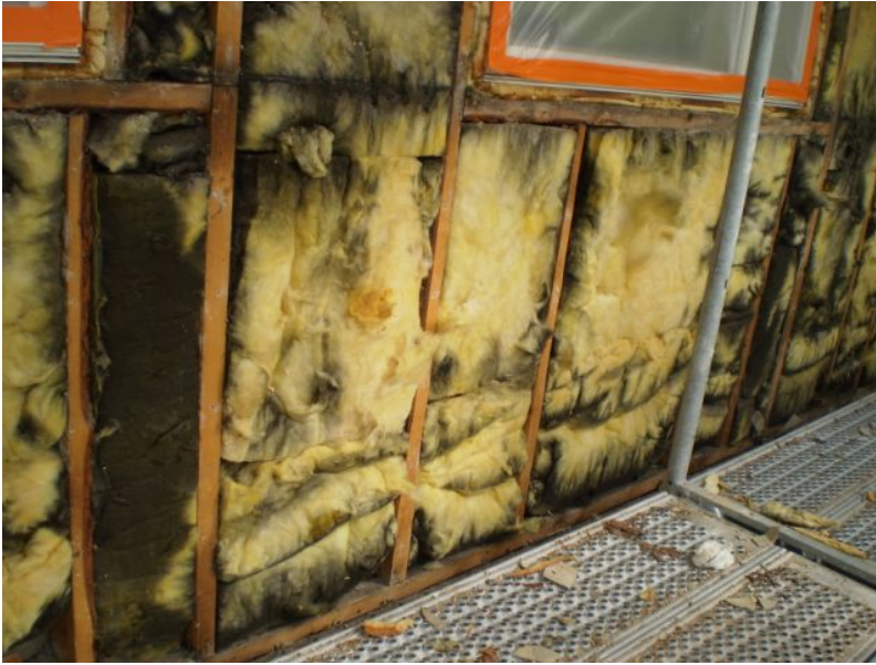
Kuva 1. Vanhan vuotavan seinärakenteen vaurioitunutta rakennetta.
