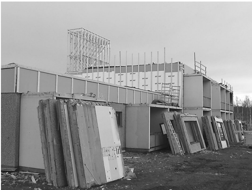
Kuva 3. Purettavat elementit joko murskattiin ja teräkset eroteltiin tai ne käytetään uudestaan kylmissä piharakennuksissa.
