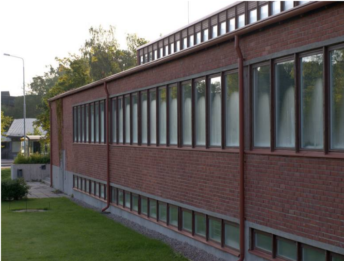
Kuva 2. Ikkunoiden lasien ulkopintaan tiivistynyttä kosteutta.
