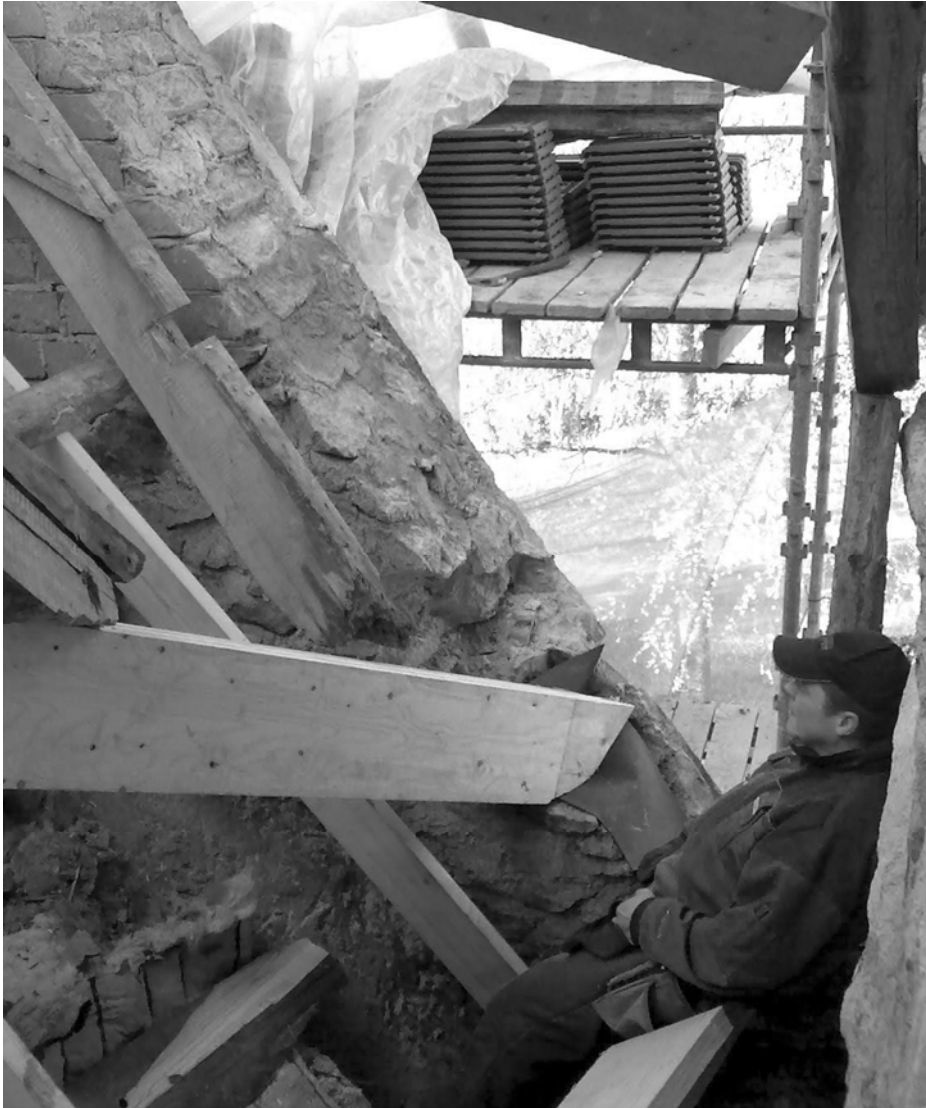
Kuva 2. Alkuperäinen rautapeltikatto 1900-luvun alusta osoittautui äänekkääksi ja jo 20 vuoden iässä se katettiin poltetulla tiilellä ja taitekohdissa kuparipellillä. Sähkökemiallinen reaktio kuparin ja raudan välillä aiheutti raudan syöpymisen lähes kokonaan ja myös kuparipeltiin syöpyi reikiä. Seurauksena oli taitekohdassa olevan kattokannakkeen ja kattotuolien päiden paha lahoaminen. Kuvassa asennetaan uutta taitekohdan pääkannaketta. Huomaa päätykolmion sekarakenne; luonnonkivi, tiili ja varhainen betoniharkko, jonka tarkempi tausta ja valmistustapa jäi selvittämättä.
