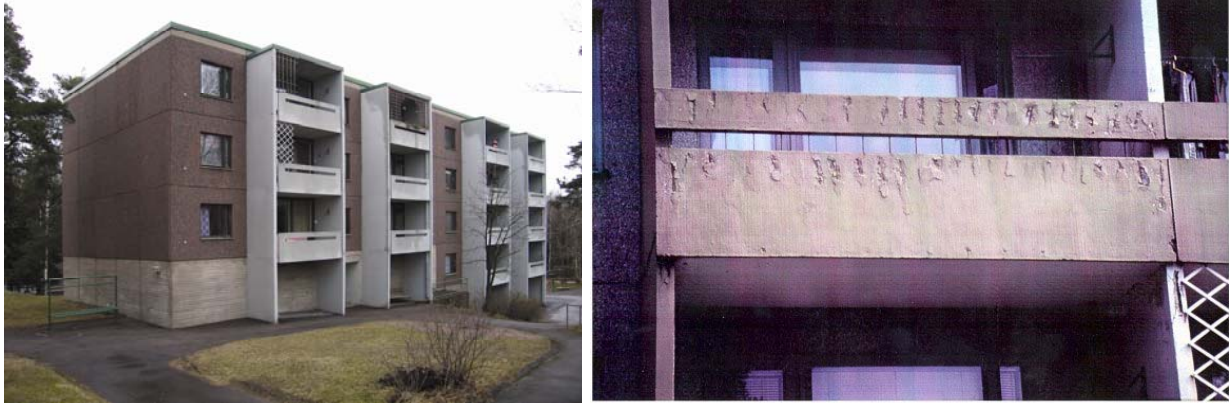
Kuva 2a ja b. Tyypillinen betonielementtikerrostalo 1970-luvulta (a), jossa sekä julkisivut että parvekkeet ovat betonielementtejä. Pitkälle edennyt ja laaja-alaista teräskorroosiota parvekekaiteessa (b).
