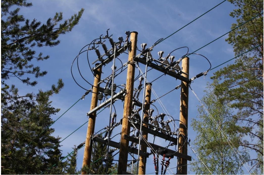
Kuva 5: Kaukokäytettävä viiden erottimen erotinasema
