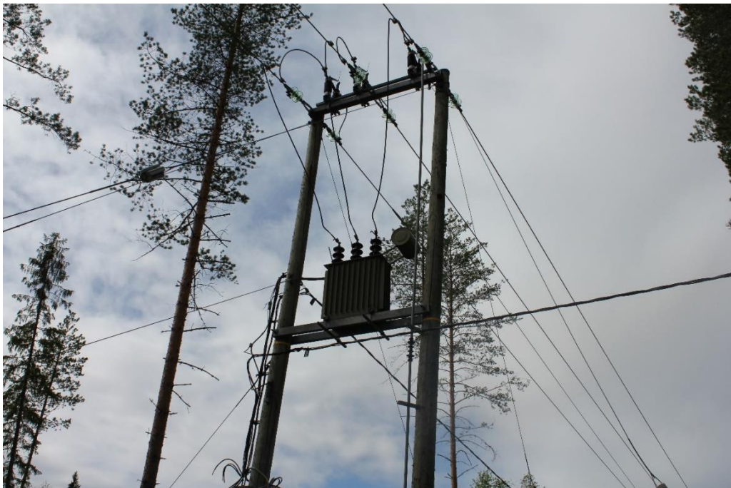
Kuva 3: Keskijännitteisen ilmajohdoverkon 2-pylväsmuuntamo
