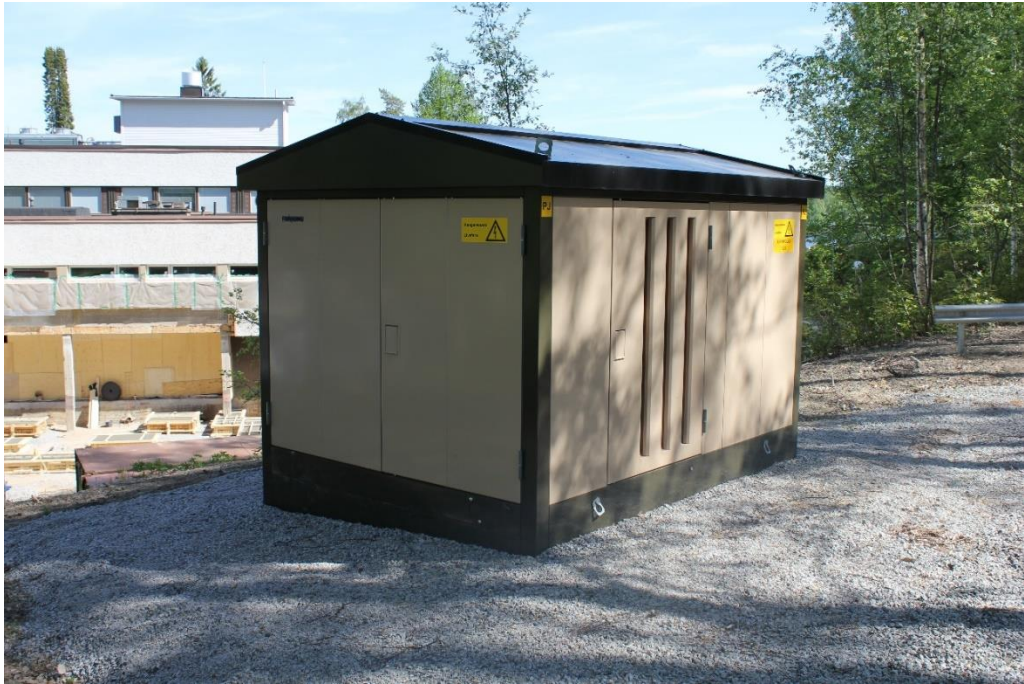
Kuva 4: Keskijännitteisen maakaapeliverkon puistomuuntamo
