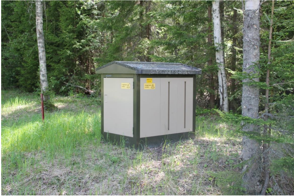
Kuva 6: Puistomuuntamotyypinen keskijänniteverkon erotinasema
