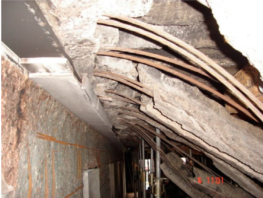
Kuva 7: Ontelolaatan liitos palkkiin ja alapinnan sortuminen (Efectis Nederland BV 2007 s. 29)
