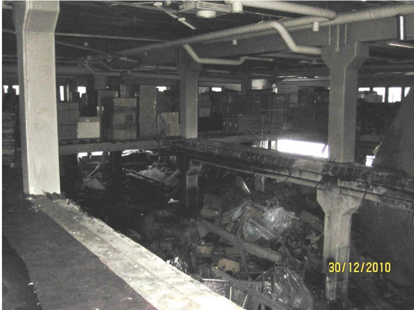
Kuva 5: Sortuneita välipohjan ontelolaattoja (Onnettomuustutkintakeskus 2010, s. 16)
