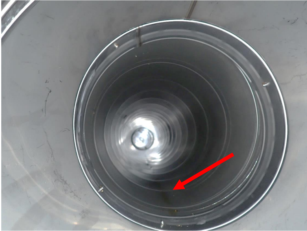
Kuva 14. Allasosaston ilmanvaihtokanavissa havaittiin öljyä
