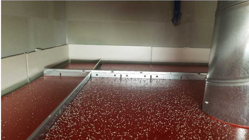
Kuva 17. Lattioiden purku- ja uudelleenpinnoittamistöiden jälkeen alakattojen päällä oli runsaasti akryylimassalattioiden purkujätettä
