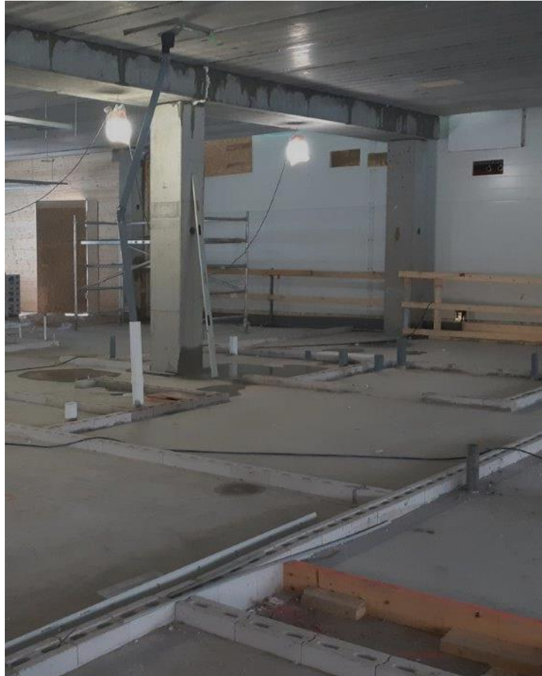
Kuva 11. Kerroksiin valunut vesi kasteli rakenteita
