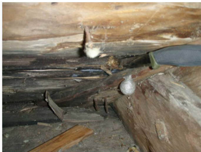
Kuva 3.1. Vesikatteen aluslaudoituksessa havaittu lahovaurio. [32]
