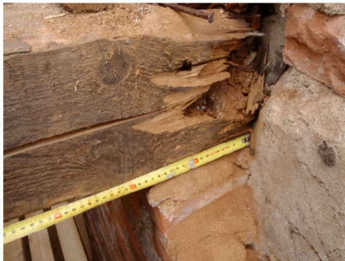
Kuva 3.3. Tiilimuriin tuetun kannattajan pään lahovaurioituminen. [32]
