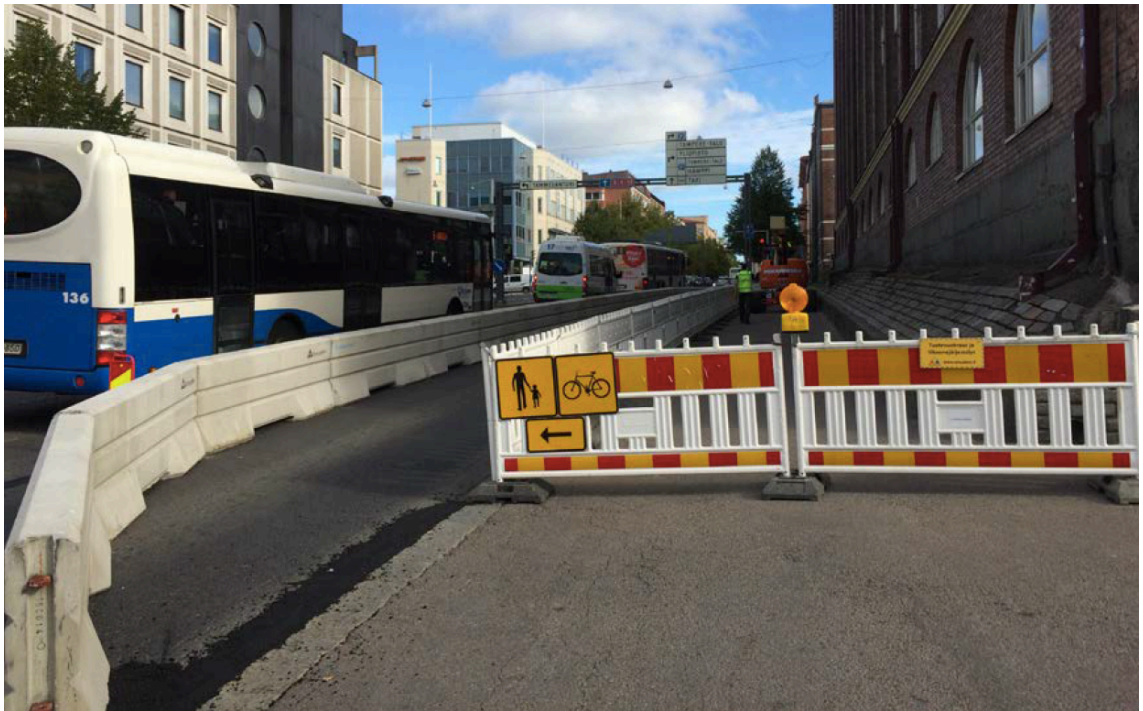
Kuva 18. Kevyelle liikenteelle ajoradan reunasta järjestetty kiertoreitti, jossa kevyt liikenne on erotettu ajoneuvoliikenteestä raskaalla suojauksella ja työmaa-alueesta muovisilla työaidoilla. [62]
