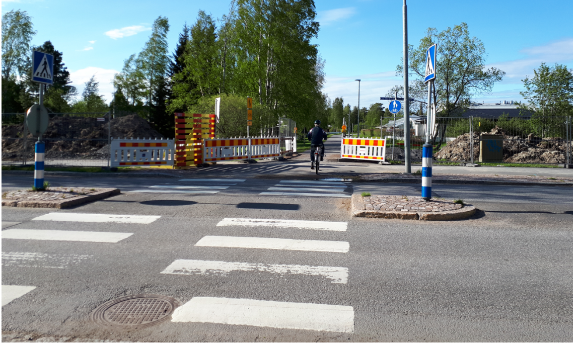
Kuva 23. Helposti havaittava kaivannon ylityspaikka.
