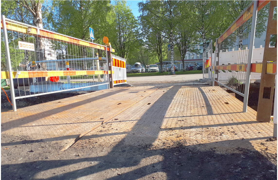
Kuva 22. Kevyen liikenteen kulkusilloissa esiintyneet turvallisuusriskit: nostoreiät sekä siltojen välinen hammastus ja rako.
