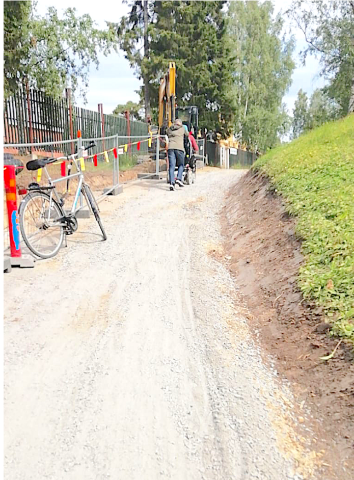
Kuva 28. Työmaa-aikaisella kevyen liikenteen kiertoreitillä oleva jyrkkä ylämäki, jonka hienorakeinen murskepinta aiheuttaa haasteita pyörätuolilla liikkuvalla.
