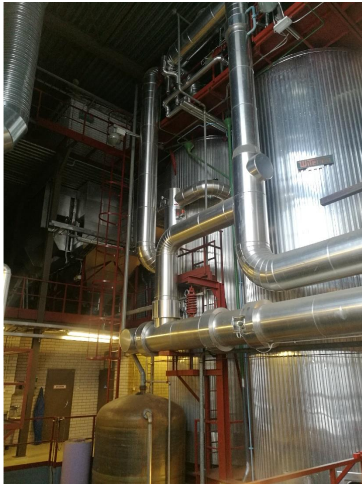
Kuva 8. Raholan kaukolämpökeskus sisältä
