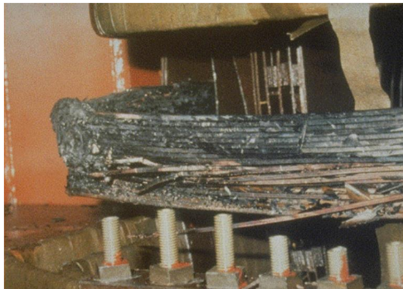
Kuva 2.12. GI-virtojen tuhoama muuntajan käämitys [31].
