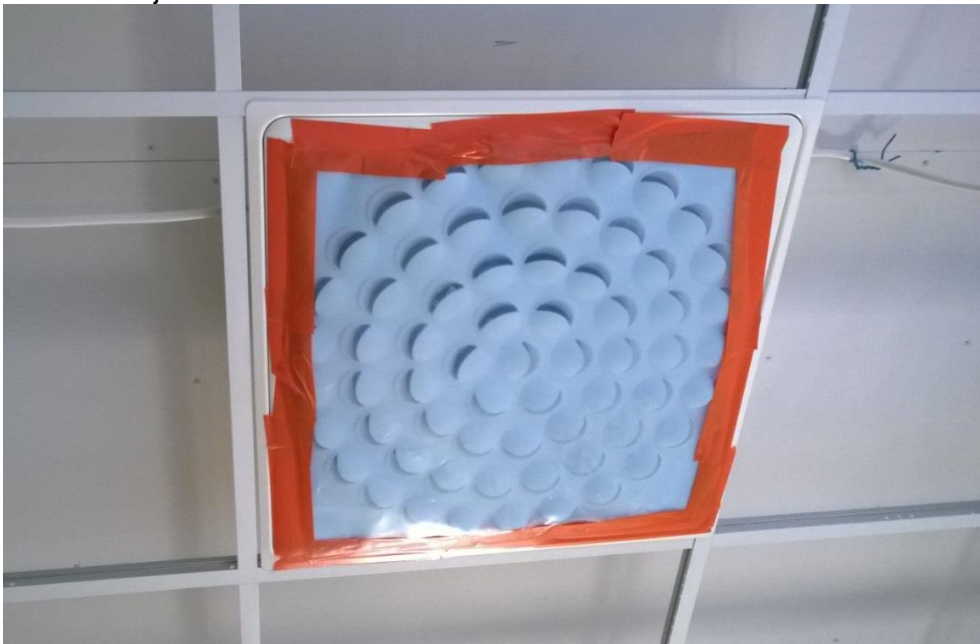
Kuva 4.33. Ilmanvaihdon suutinhajottajan pölysuojaus tutkimuskohteessa, jossa vaatimuksena on rakennustöiden ja ilmanvaihtojärjestelmän P1-puhtausluokka.
