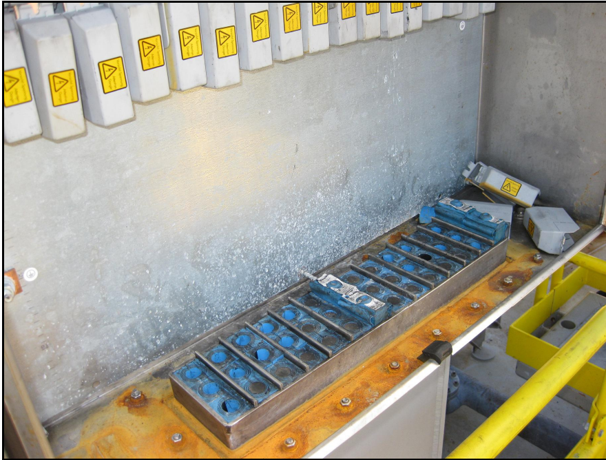
Kuva 3.9. Kytentäkotelon suojaluokitus on IP56. Sen sisällä, erityisesti pohjalla, näkyy runsaasti kosteutta. Lisäksi kotelon pohjalla on havaittavissa jo selvää ruuvien ja muttereiden ruostumista.
