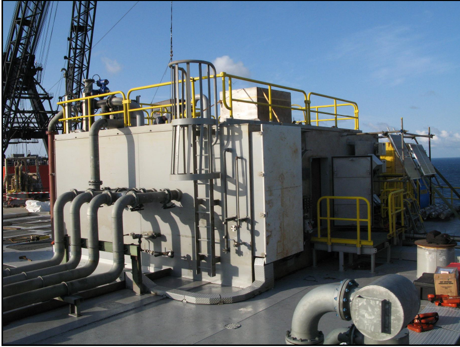
Kuva 3.2. Lautan kannella oleva kansimökki, jonka sisällä ovat MCC, PLC ja virtalähdekotelo.
