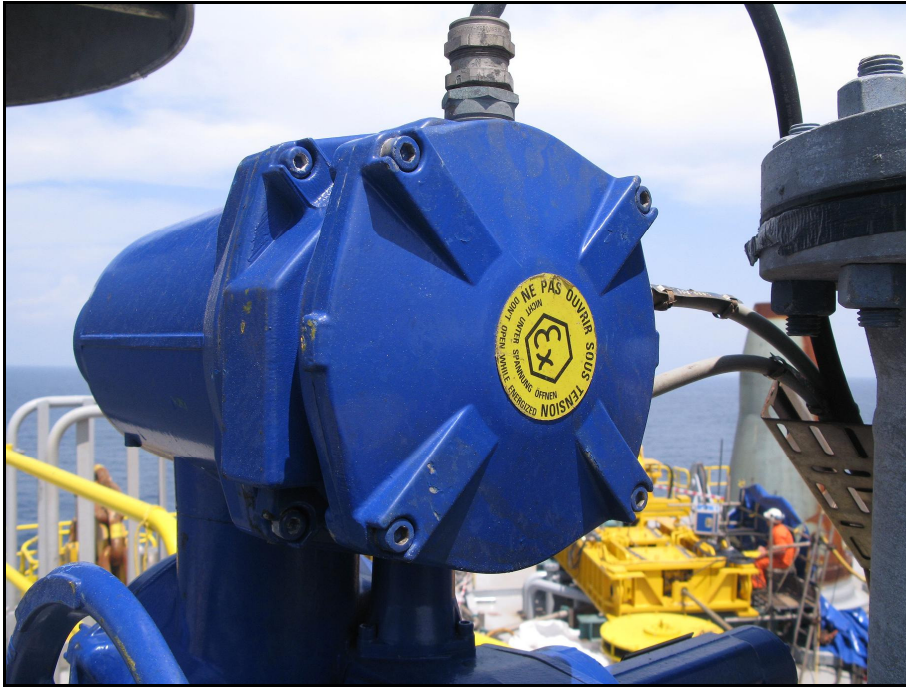
Kuva 3.11. Ballast-järjestelmän kauko-ohjattu venttiilin toimilaite, jonka suojakoteloitiluokka on IP68.
