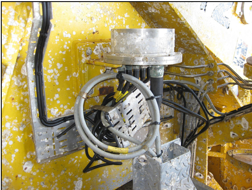
Kuva 3.8. Norjalaisten toimittama ankkurivinssin kytkentäkotelo (IP68), joka on normaalisti tuotantolautan kannen päällä eikä vedessä. Kuljetuksen aikana kytkentäkotelo saattaa kuitenkin olla veden alla pitkäänkin. Tämä kotelo oli vedessä 9 kuukautta. Valkoiset jäljet kytkentäkotelossa ja seinillä ovat ostereiden ja muiden merenelävien osia ja jätöksiä.
