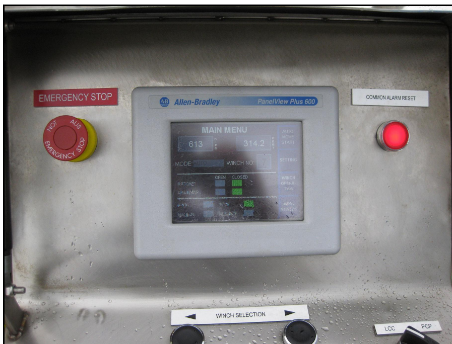
Kuva 3.10. Ankkurointijärjestelmän Allen-Bradley:n ohjauspulpetti, jossa on kosteusnäyttö. Näytön sisällä näkyy kosteutta.
