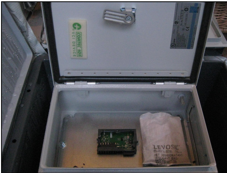
Kuva 6.7. Kytkentäkotelon 3 sisällä on Levosil ja Cortec 101.
