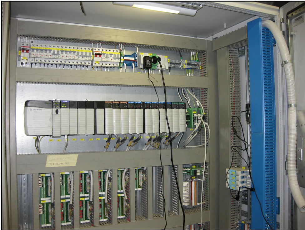
Kuva 3.4. Kansimökin sisällä oleva PLC-kaappi. Kaapin suojaluokitus on IP54.
