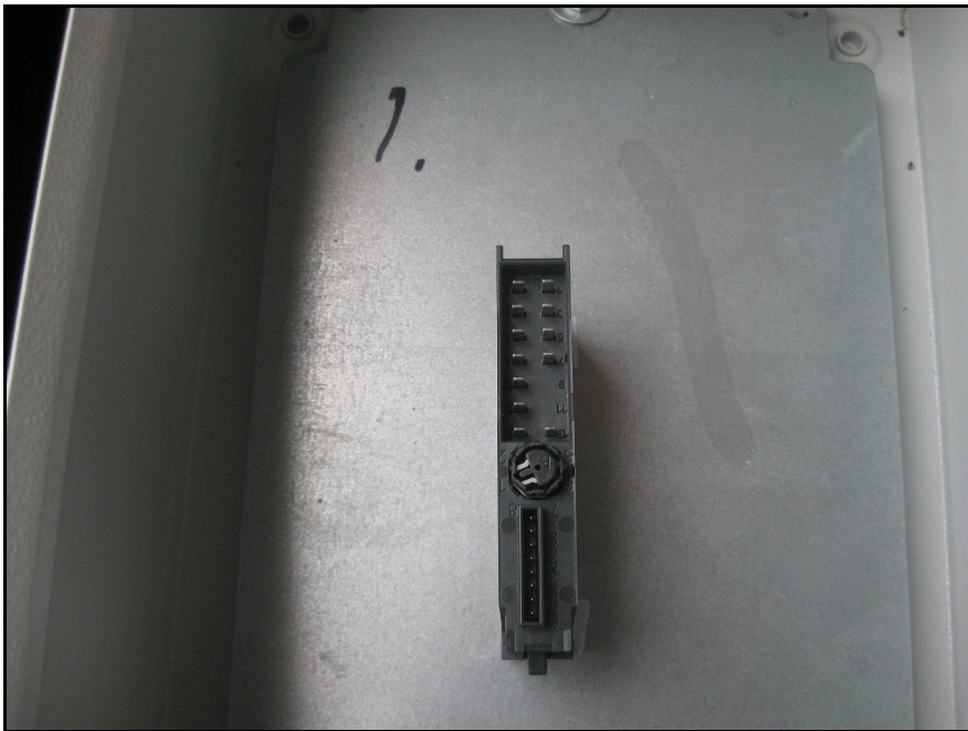
Kuva 6.9. Kytentäkotelo 1, kosteuden havaitsi kokeilemalla sormella pohjalevyn pinnasta.
