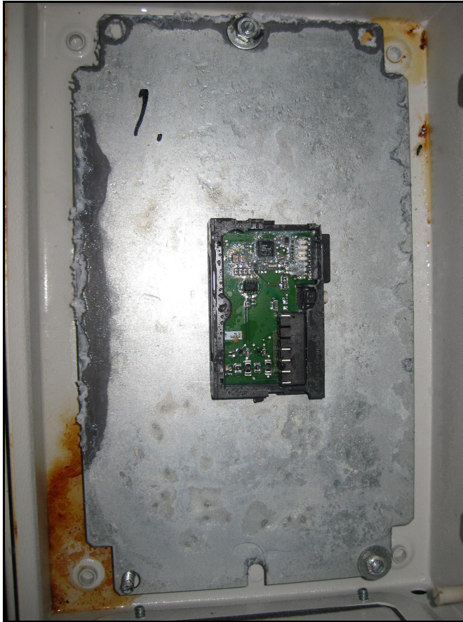
Kuva 6.20. Kytentäkotelon 1 sisäosissa näkyi reilun kuukauden jälkeen ruostevauriota. Pohjapellin reunoilla näkyi myös suolamuodostumia.
