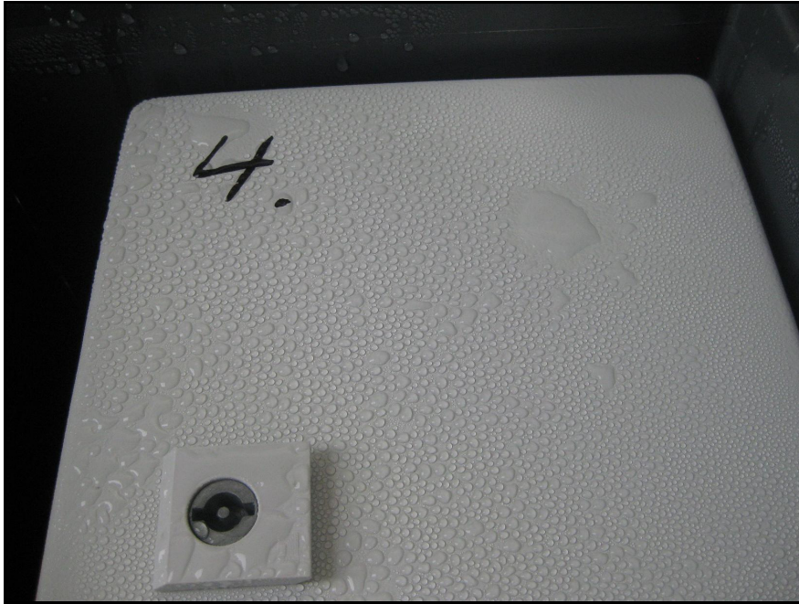
Kuva 6.14. Kytentäkotelon 4 päällä olevia kosteuspisaroita, vertaa kuva 6.3.
