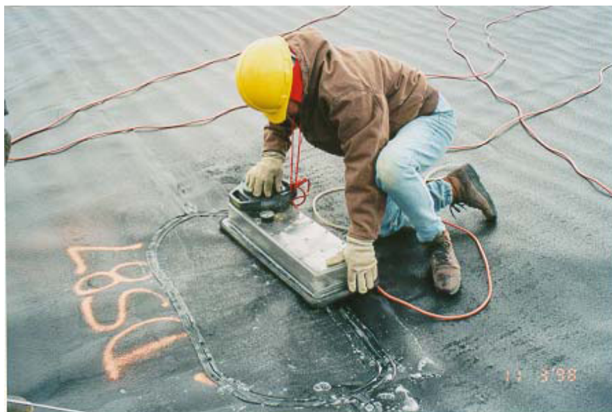
Kuva 3.5 Geomembraanin ainetta rikkoman testaus, vakuumikoe. (Phaneuf 2005)
