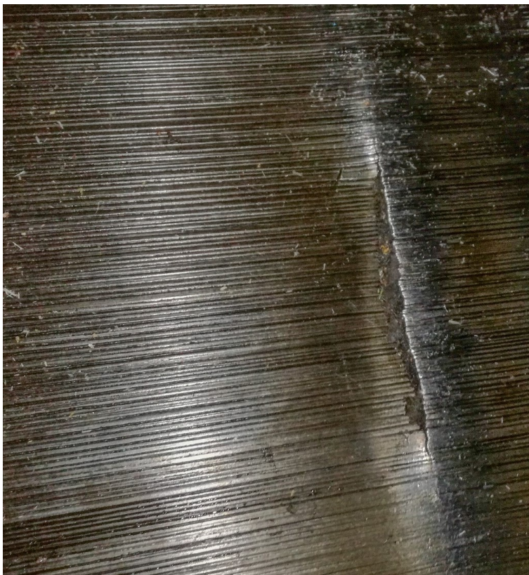
Kuva 54. Laitalevyn rikkoutuminen tukirakenteen kohdalta.
