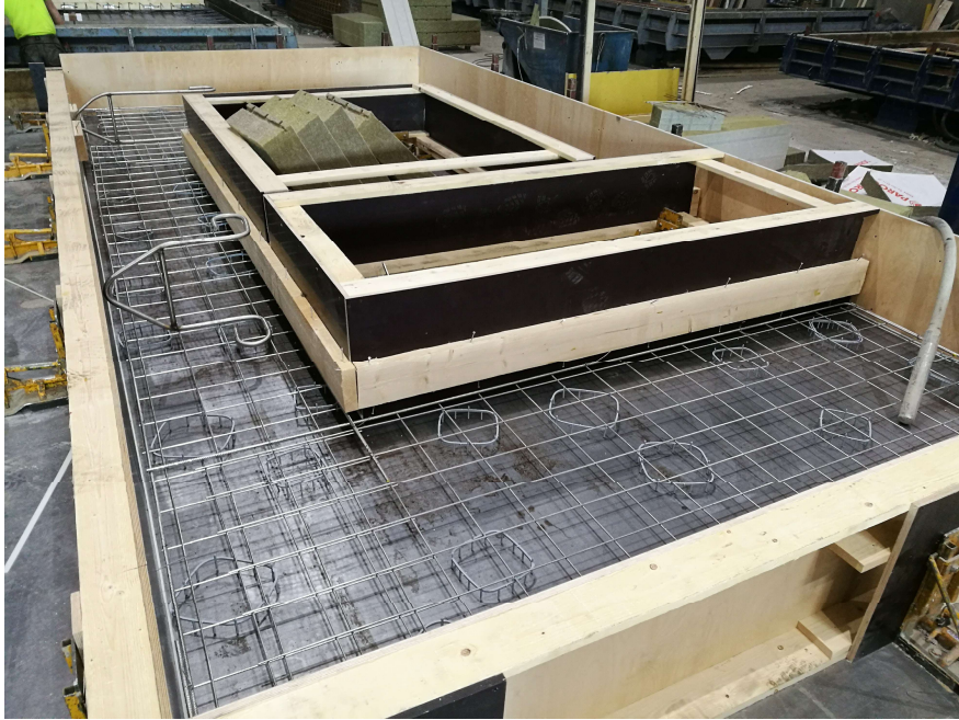
Kuva 10. Julkisivuelementin ulkokuoren raudoitus
