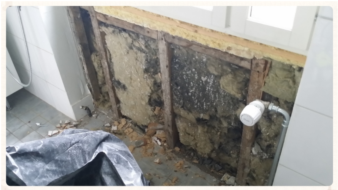
Kuva 3. Kosteusvaurion aiheuttamaa homekasvustoa ulkoseinässä (Sisäilmari Oy 2017)
