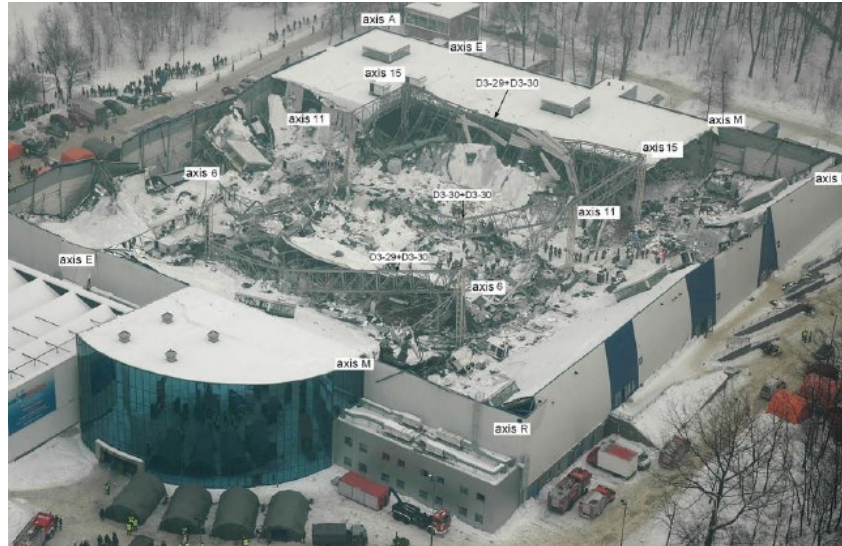
Kuva 38. Katowicen messuhalli katastrofin jälkeen. [5]
