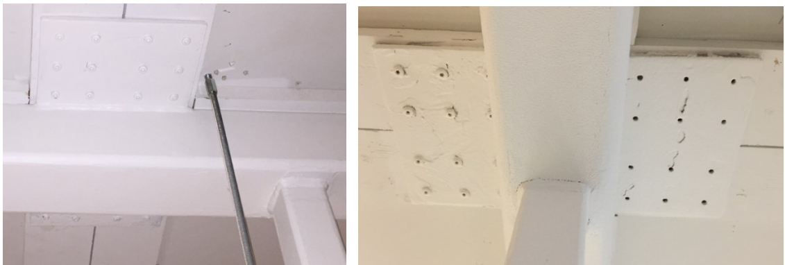
Kuva 64. Kattoelementtien kiinnityksessä puutteita.
