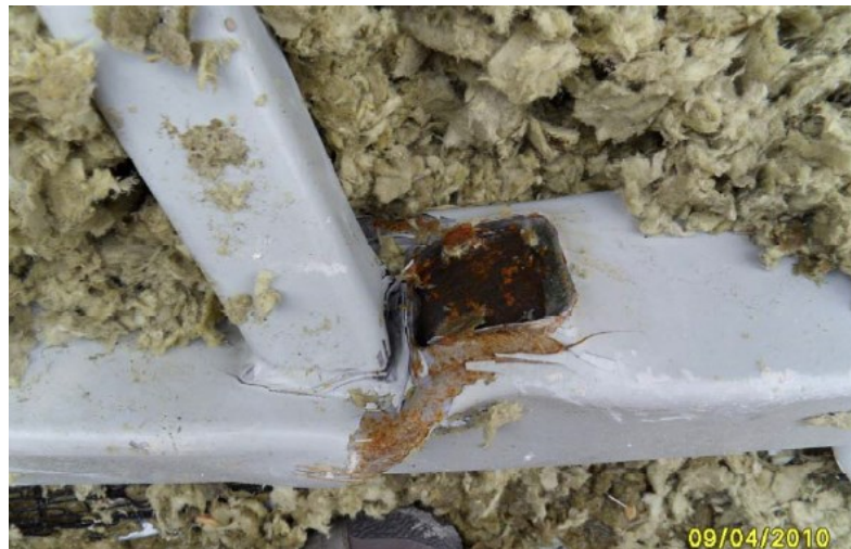
Kuva 51. Paarteista repeytyi irti diagonaaleja siten, että pala paarretta leikkautui irti ja jäi kiinni diagonaalin päähän. [3]
