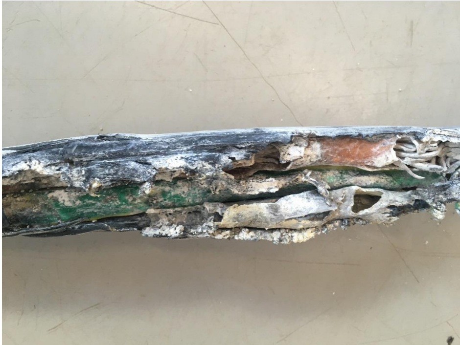
Kuva 8. Pitkällä aikavälillä vaurioitunut vesistöissä käytetty AXMK.
