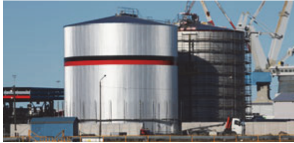
Kuva 17. Vielä kuvanottohetkellä vuonna 2010 työn alla olevia kohdeyrityksen toimittamia varastointisäiliöitä satama-alueella [49].
