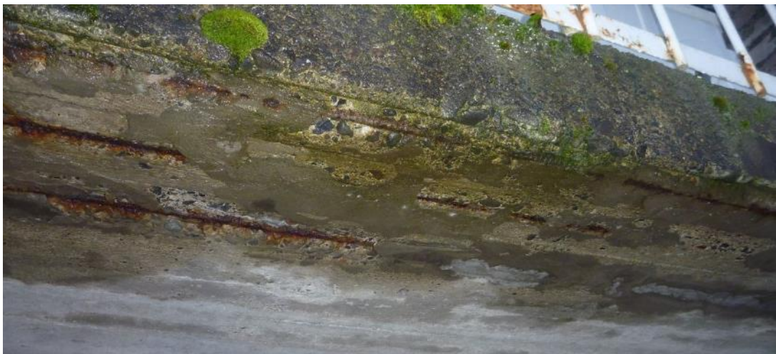
Kuva 17 Karbonatisoitumisen aiheuttamaa teräskorroosiota parvekelaatan alapinnalla, (WSP Finland Oy 2016).
