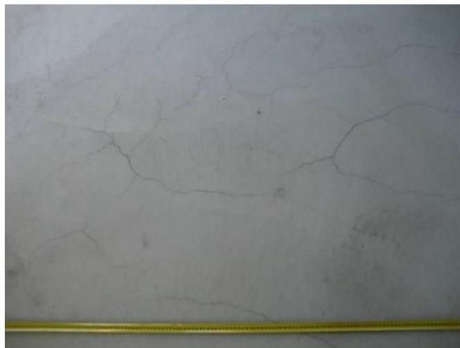
Kuva 6 Pintahalkeilua valunjälkeisenä aamuna puuttellisen jälkihoidon seuraksena. (Komonen 2012).
