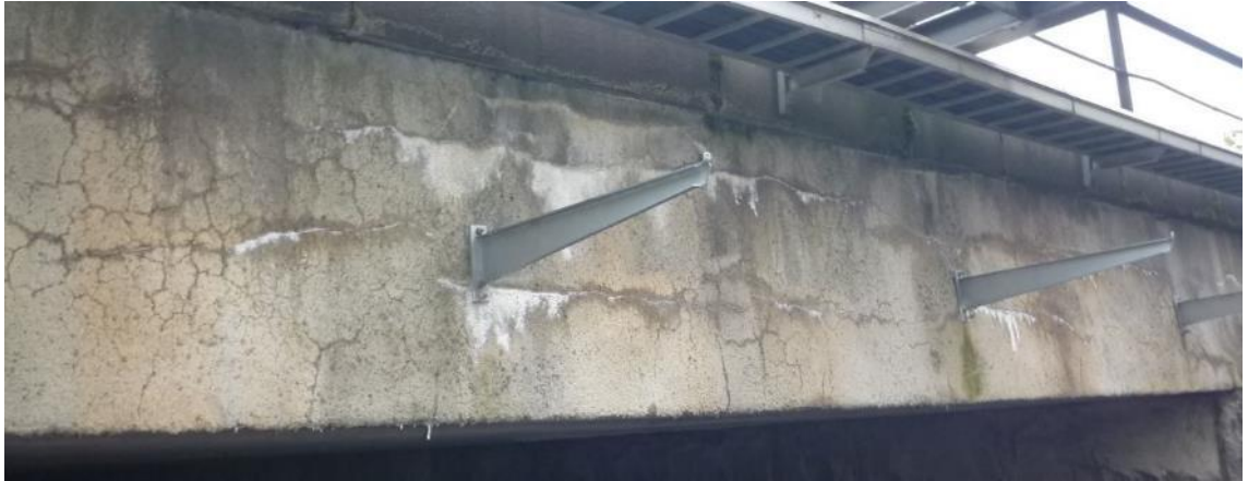
Kuva 9 Pakkasrapautuman aiheuttamaa verkkomaista halkeilua rautatiesillan sivupalkissa (WSP Finland Oy).
