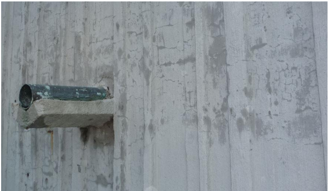
Kuva 10 Pakkasrapautuman aiheuttamaa halkeilua kirkontornin julkisivussa (WSP Finland Oy).
