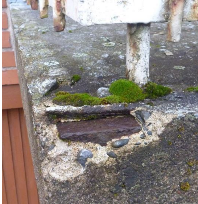
Kuva 16 Teräskorroosion ja pakkasrapautuman aiheuttama parvekelaatan kulman lohkeama, (WSP Finland Oy, 2016).
