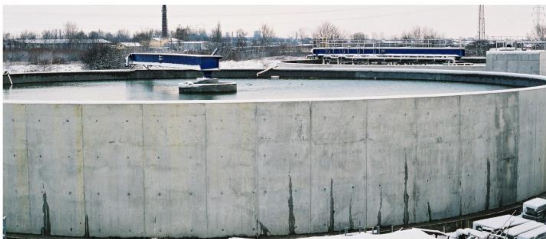
Kuva 82 Säiliörakenteessa havaittuja halkeamia säiliön tiiveyden testaamisen yhteydessä.
