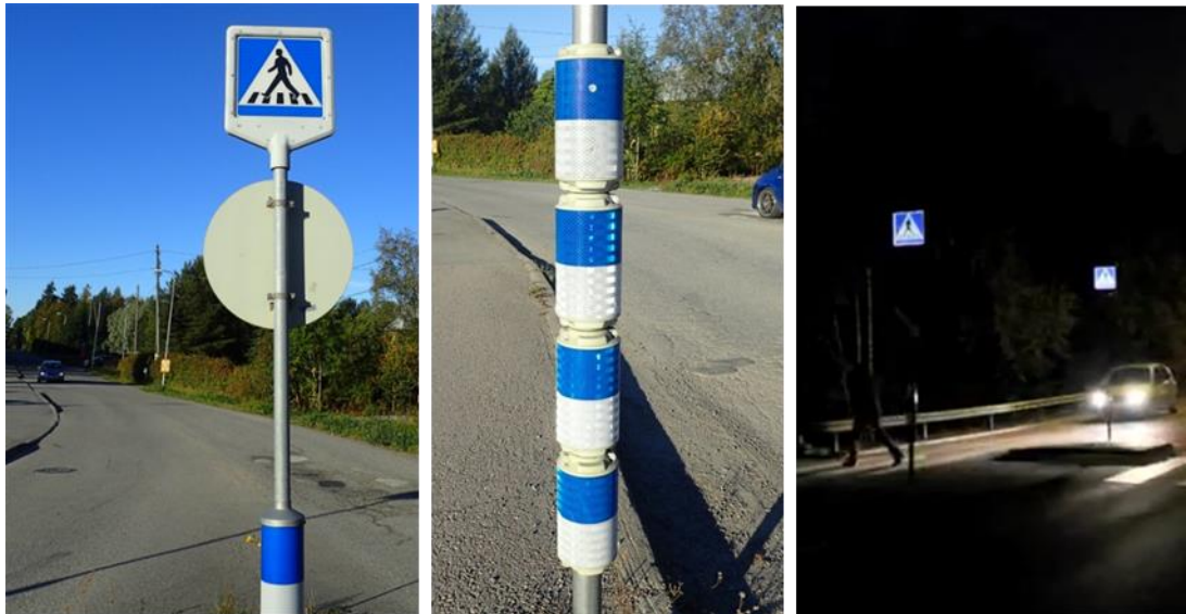
Kuva 23. Esimerkki suojatien huomiovalojärjestelmästä, jossa suojatie-merkkiin ja liikennemerkkipylvään havainnekapseleihin syttyy valo jalankulkijan saavuttaessa suojatien reunan.
