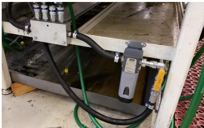
Kuva 5.4 Paineilmaverkon esisuodatin, kuvassa oikealla. Suodattimessa on myös kondenssivedenerotus.
