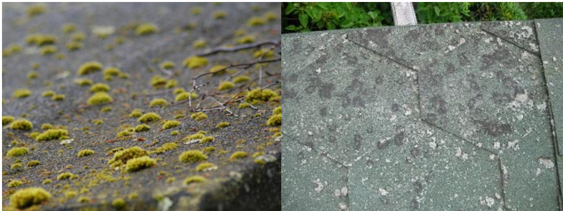
Kuva 9: Kasvustojen valtaamia bitumikattorakenteita [25–26]
