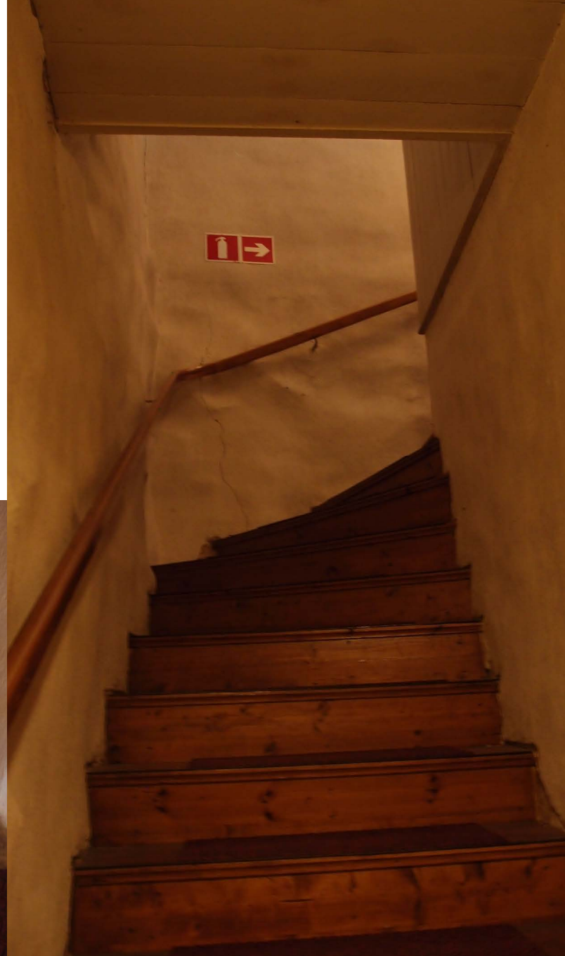
Kirkkosalin käsisammuttimen kyltti on turha, mutta parven portaissa kylttiä on käytetty tarkoituksenmukaisesti.
