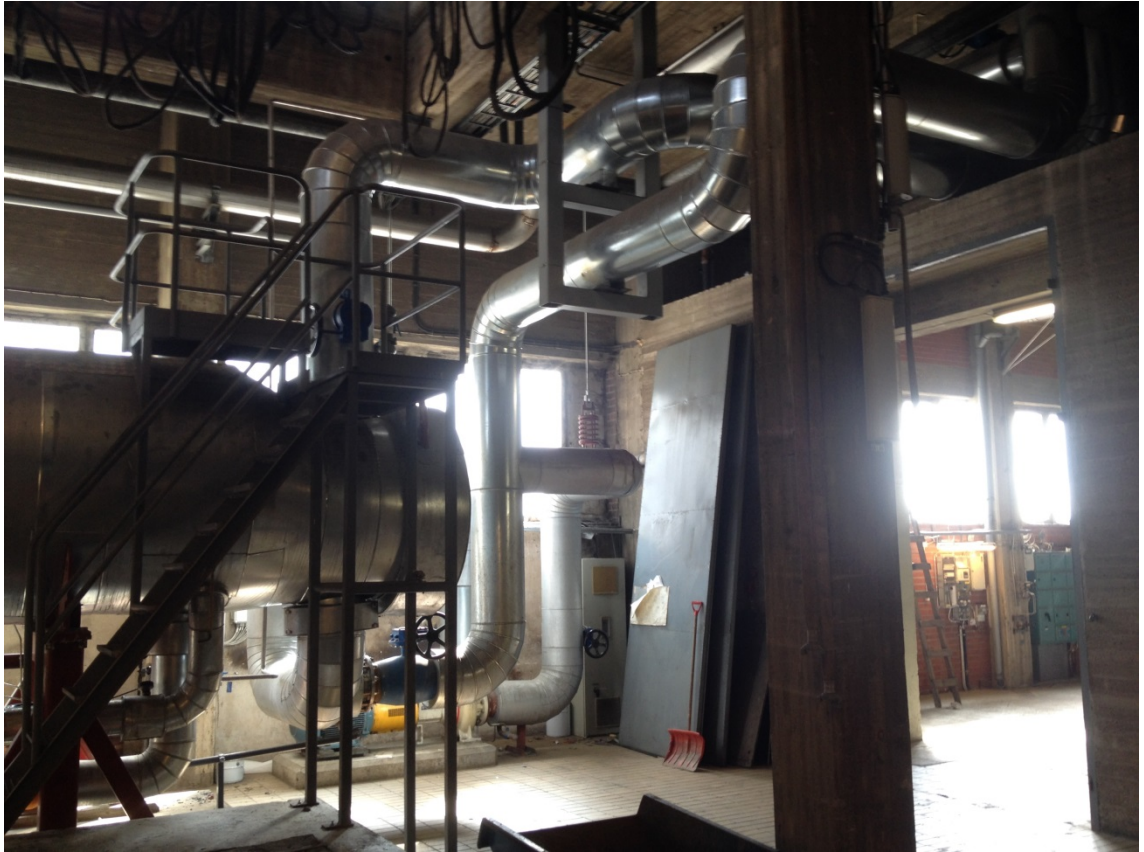
Kuva 14. Kaukolämmönvaihdin ja kaukolämpöveden meno- ja paluulinjat sekä varakattilahuoneen sisäänkäynti.
