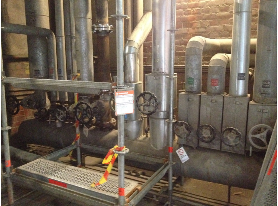
Kuva 12. Höyrytukki ja koelaitteiston höyrylinja.
