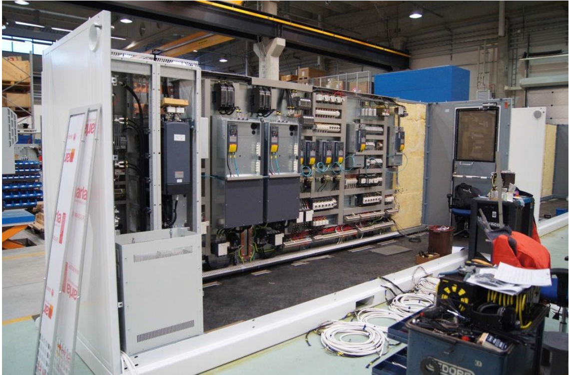
Kuva 6.11. Avoin sähköhuone (Zerust 2015, s. 4).
