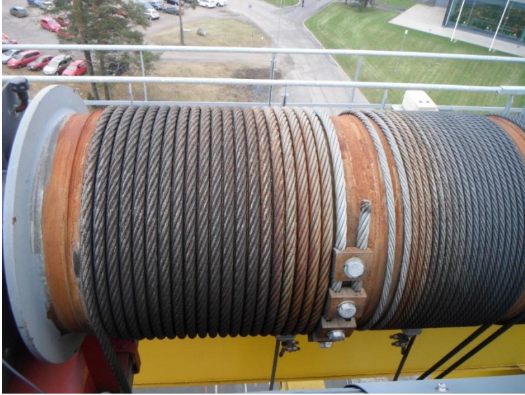
Kuva 6.4. Köysitela, joka on osittain ruosteessa.
