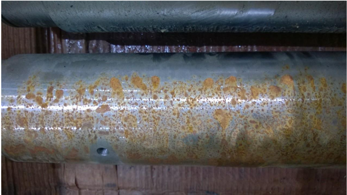
Kuva 6.16. Hieman ruostunut Zerust Perigol 100:lla suojattu akseli.
