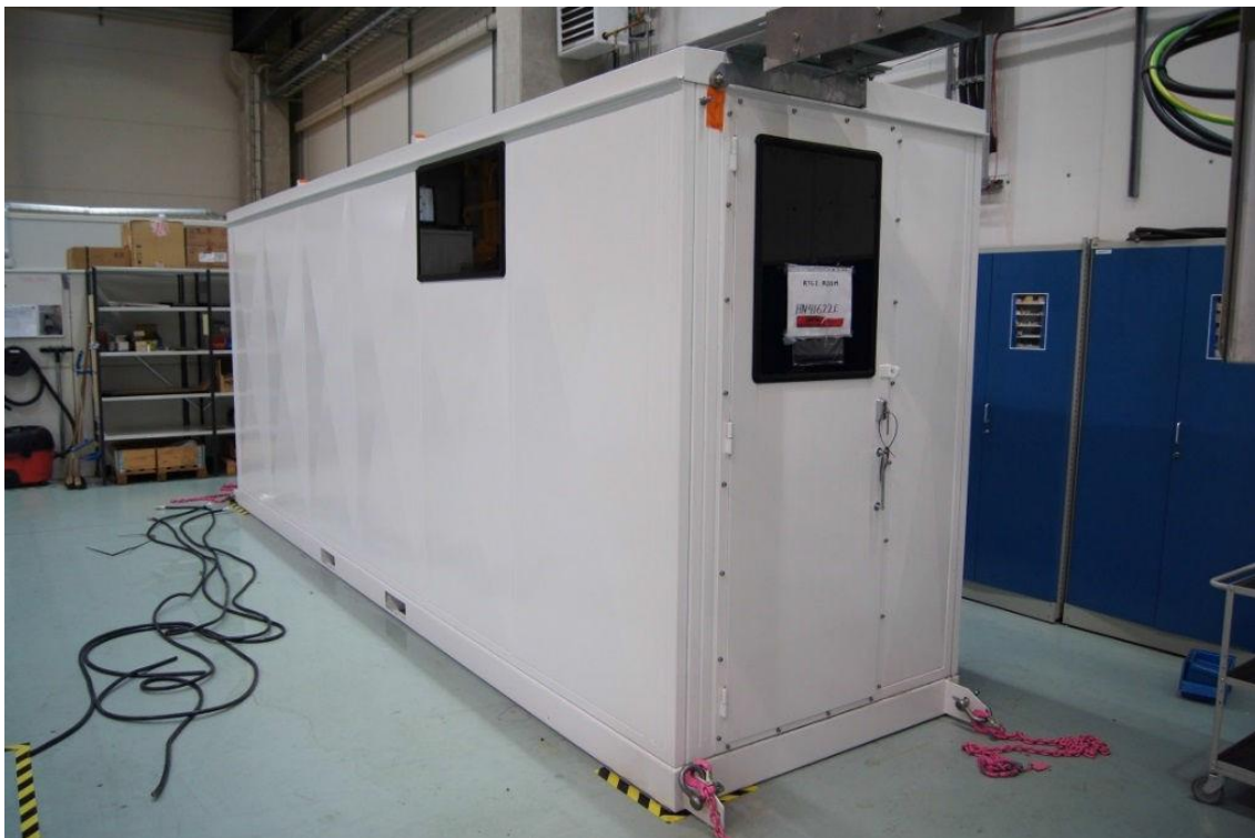
Kuva 5.4. RTG-nosturiin kuuluva sähköhuone kokoonpantuna (Zerust Oy 2015, s. 3).
