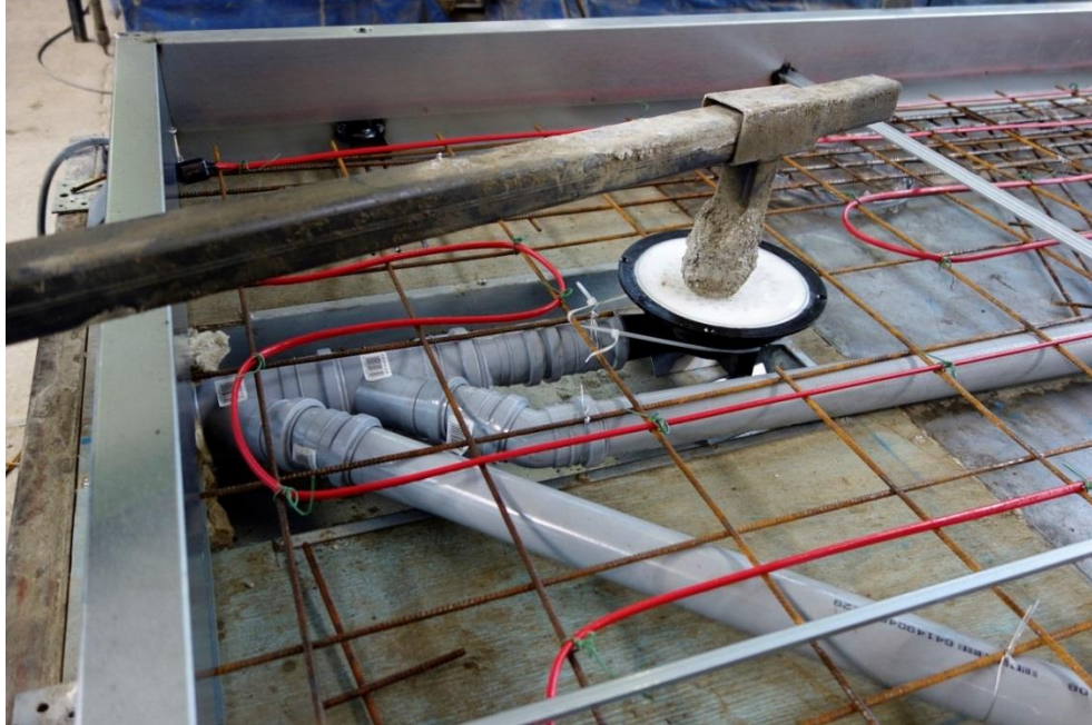
Kuva 3.3. Kylpyhuone-elementin pohjalaatta valmiina betonointia varten. Muottiin on asennettu talotekniikka, harjateräsverkko ja lattialämmityskaapelit.
