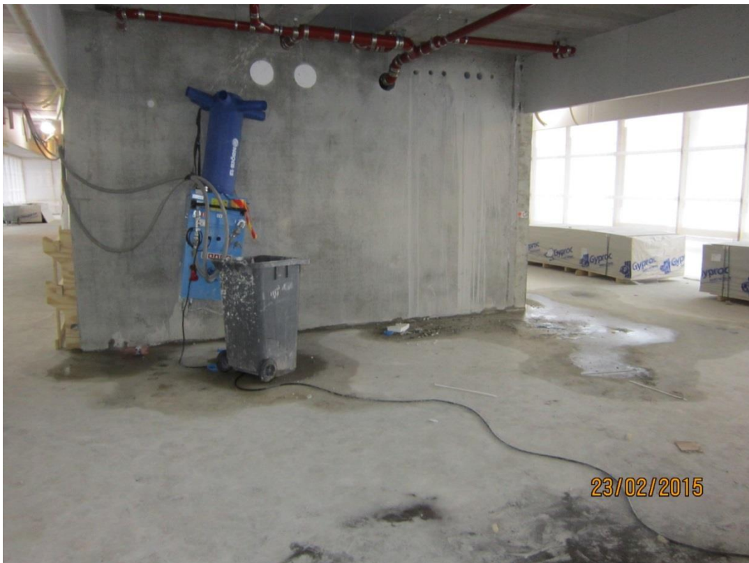
Kuva 37. C-talo, 4.krs, case 2 alue saanut lisäkosteutta (Lemminkäisen Ilmalanrinne 1 työmaa).
