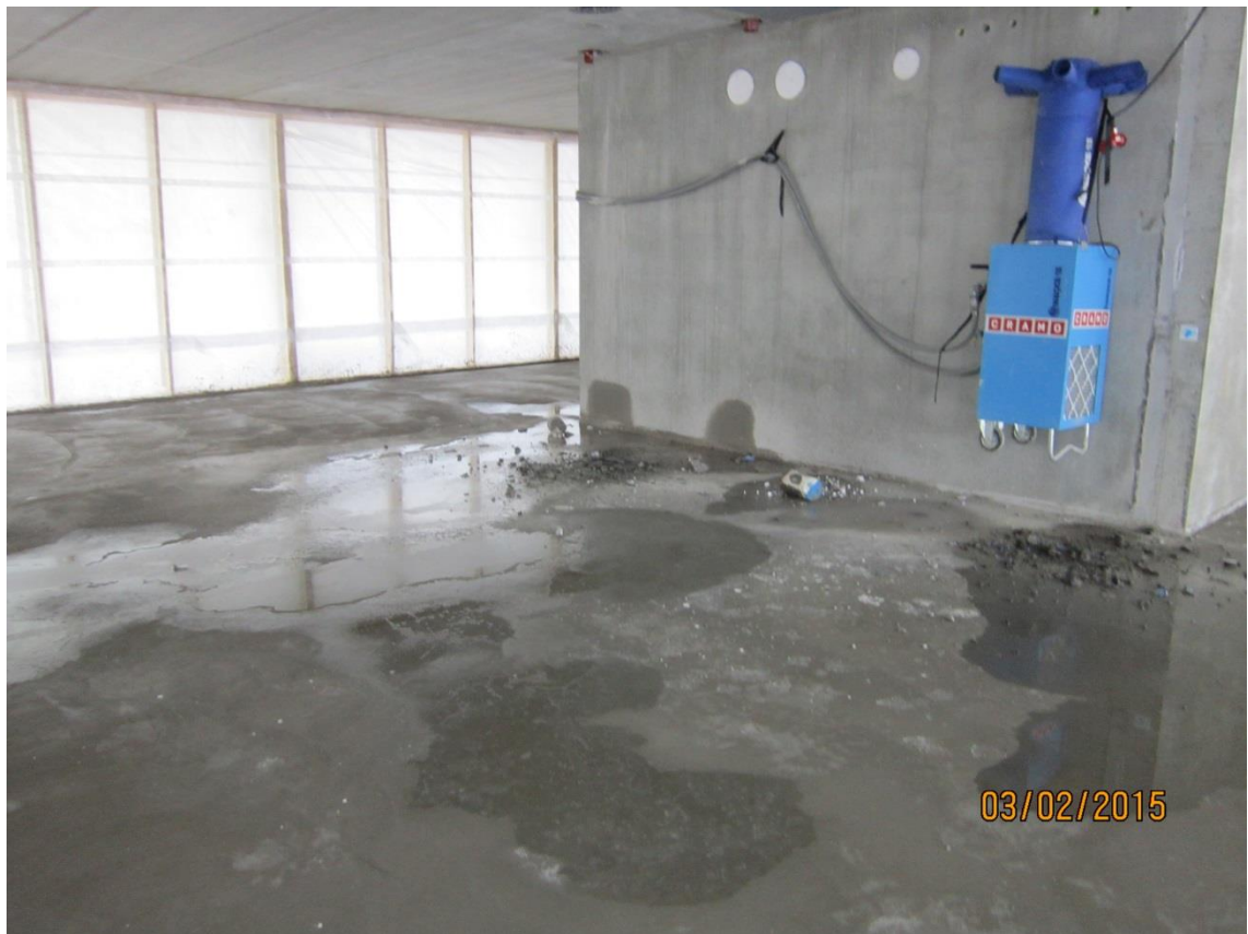
Kuva 27. Case 1 valun jälkeisenä päivänä (Ilmalanrinne 1, C-talo, 3.krs, eteläpuoli, 3.2.2015).
