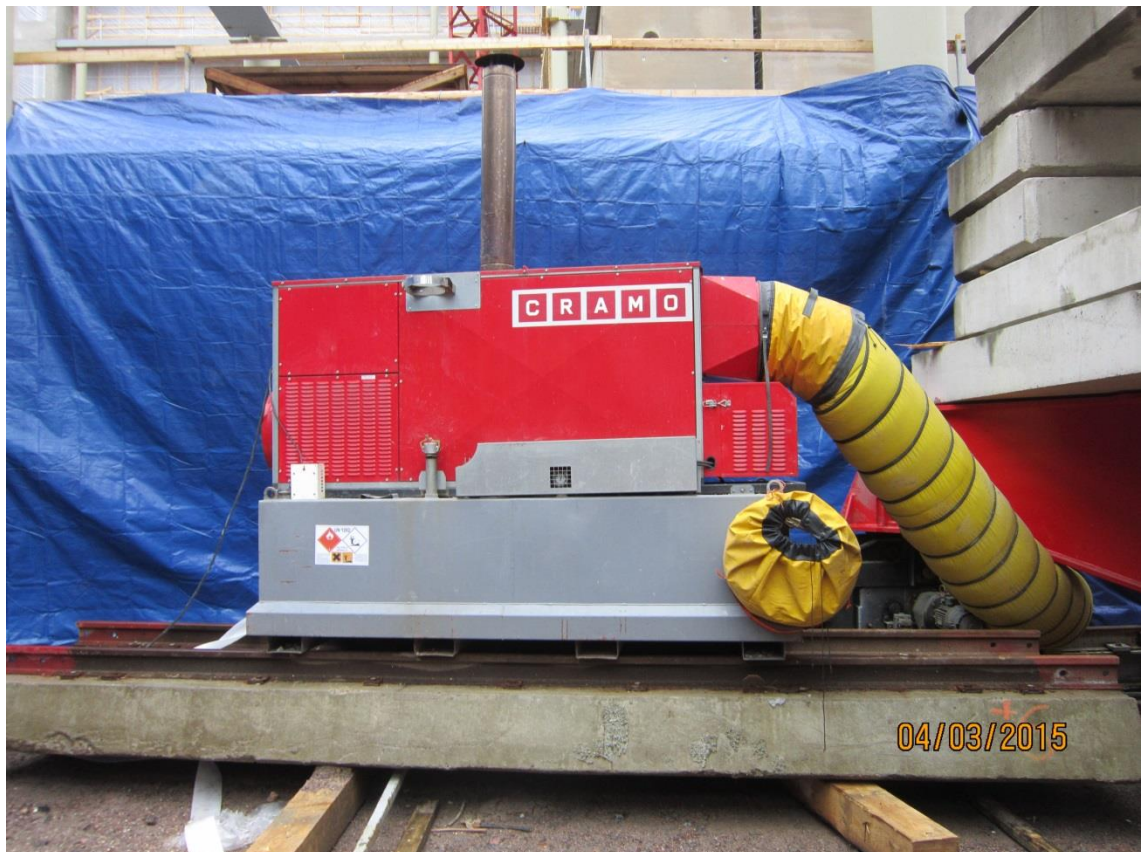
Kuva 10. Polttoöjlämmitin eli Heatmobil (Lemminkäisen työmaa Ilmalanrinne 1, 4.3.2015)
