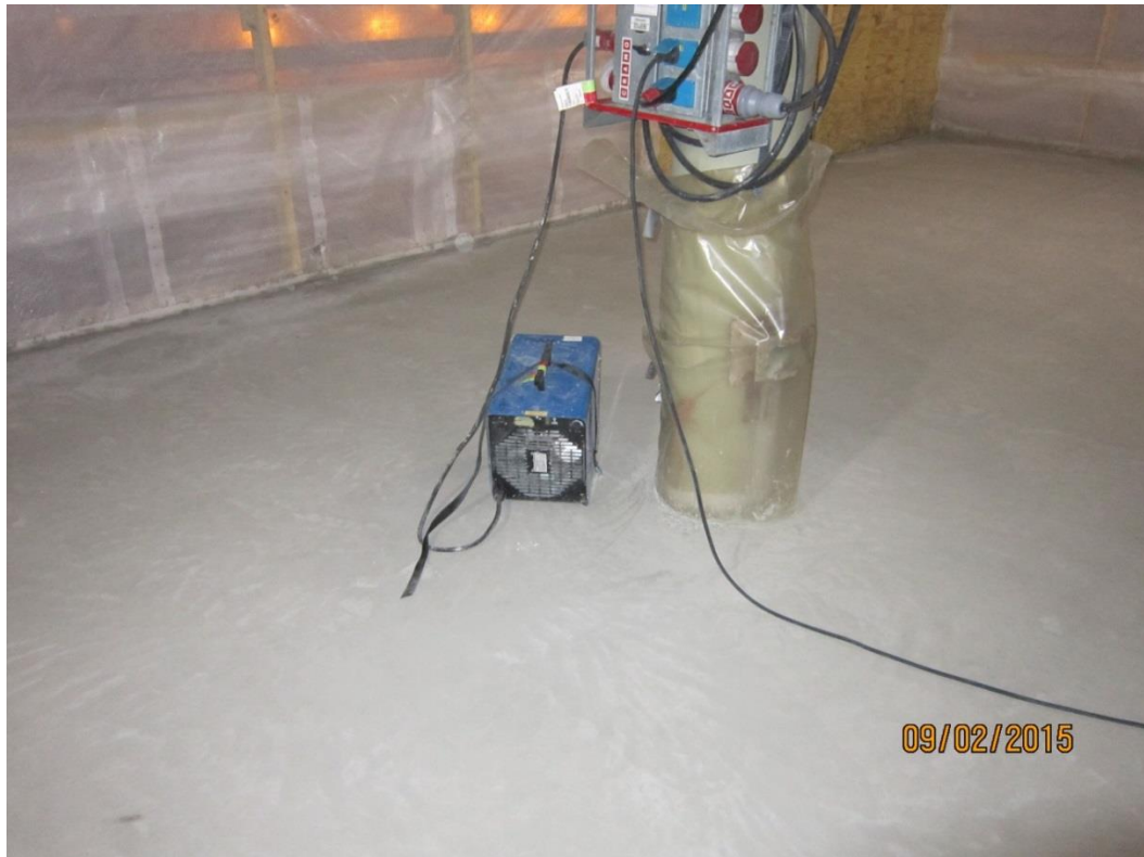
Kuva 9. Sähköpuhallin (Lemminkäisen Ilmalanrinne 1 työmaa 9.2.2015).
