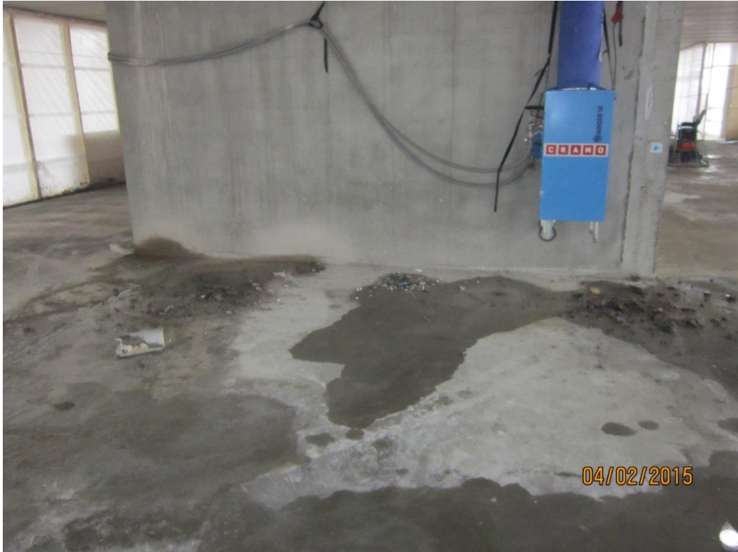
Kuva 36. C-talo, 3.krs, case 1 alue saanut lisäkosteutta (Lemminkäisen Ilmalanrinne 1 työmaa).
