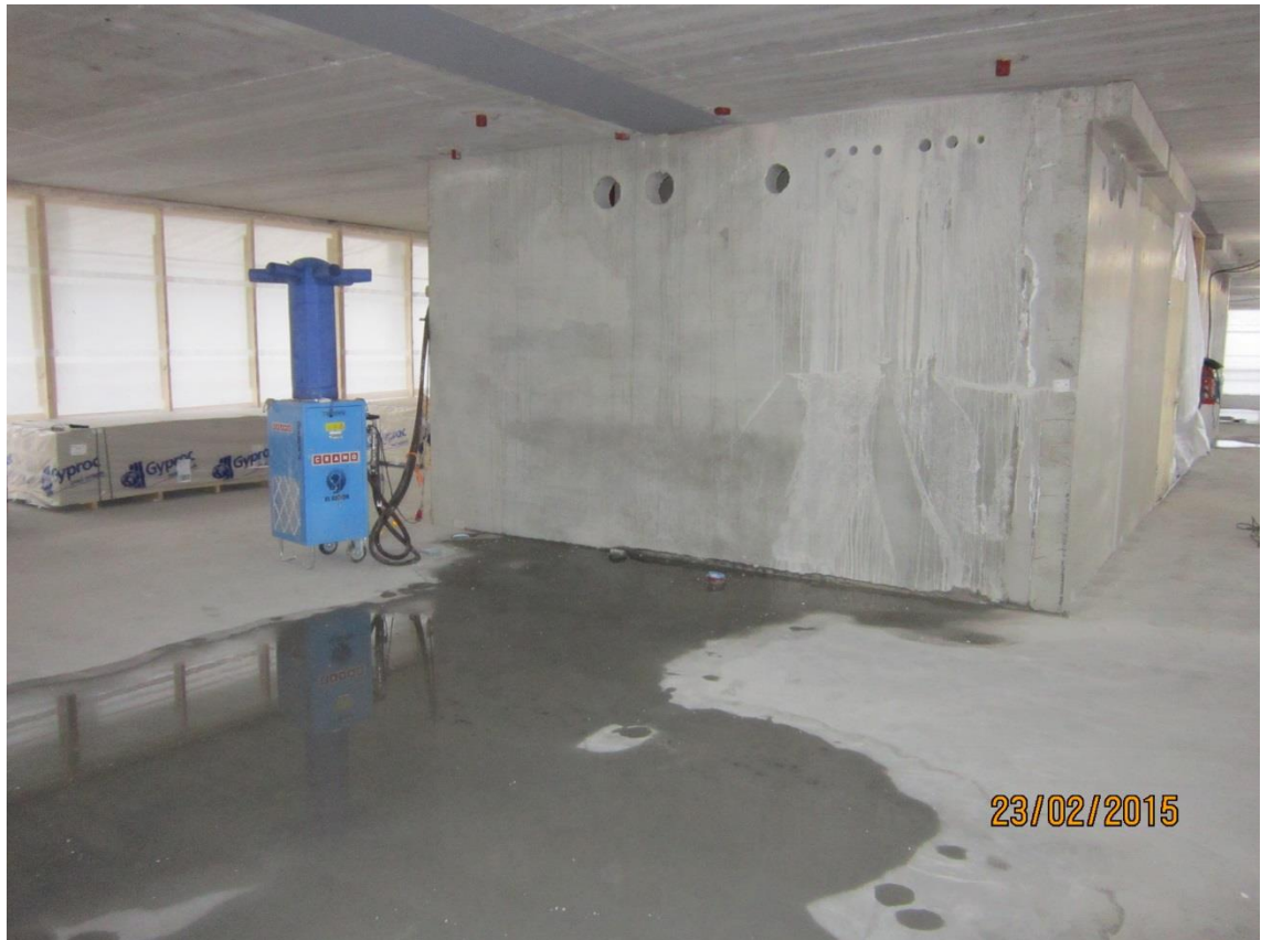
Kuva 38. C-talo, 5.krs, case 3 alue saanut lisäkosteutta (Lemminkäisen Ilmalanrinne 1 työmaa).
