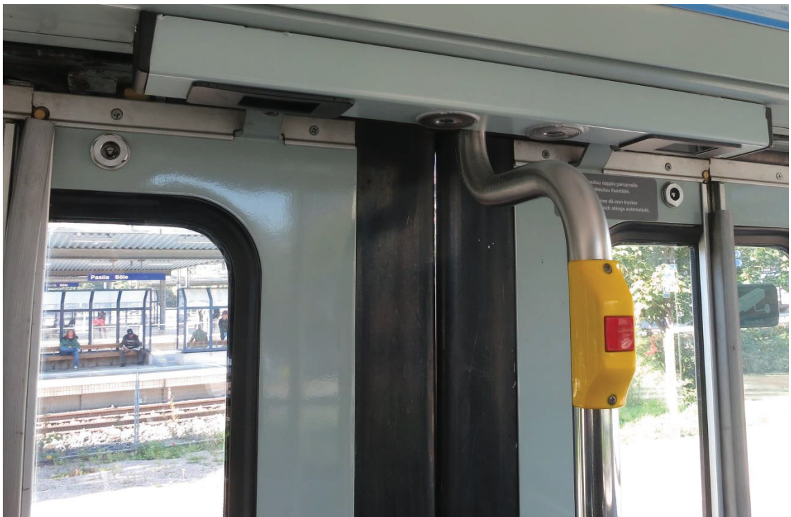
Kuva 12. Laskentalaitteet asennettuna MLNRV II-tyyppin vaunussa [28].
