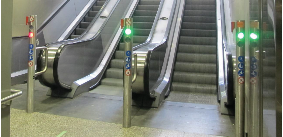
Kuva 36. Valokennolaskurit liukuportaiden alapäässä [28].
