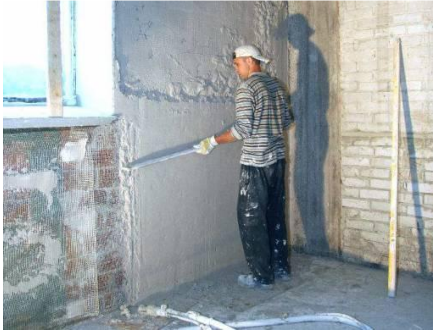
Kuva 5.41. Kipsilaastilla voidaan tasoittaa seinäpintoja koneellisesti tai käsin. Työskentelyaikana lämpötilan on oltava vähintään +10 °C. (maxit Oy Ab 2006.)
