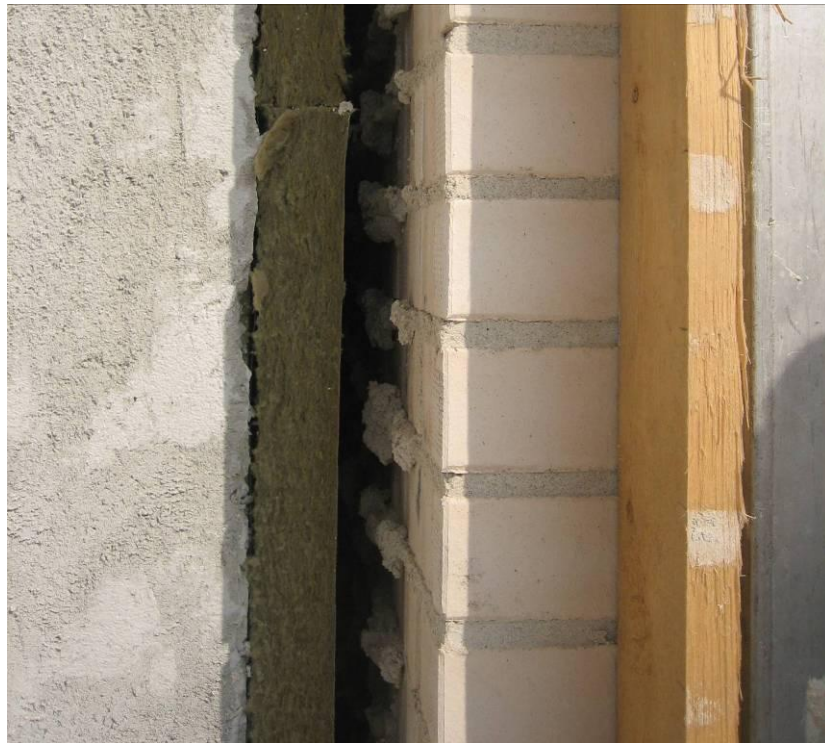
Kuva 5.27. Tiilikuorimuurin ja mineraalivillaeristeen välissä tulee olla vähintään 40 \text{ mm} tuuletusrako, kuten kuvassa. Käytännössä tuuletusraon toteuttaminen voi olla haastavaa, koska laastipurseet saattavat tukkia raon.
