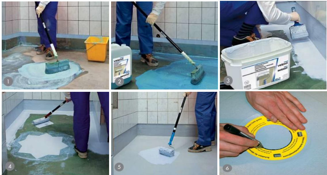
Kuva 5.7. Vedeneristysjärjestelmä koostuu useasta eri tuotteesta ja työvaiheesta, joista muutamia on esitetty kuvasarjassa. Eri tuotekerrosten tasaisessa levittämisessä auttavat tuotteiden selkeät värierot. (maxit Oy Ab 2008a.)
