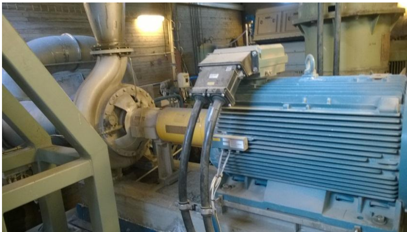
Kuva 3. Pumppu VE318 toiminnassa.
