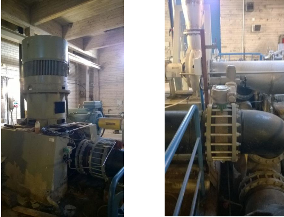
Kuva 4. Pumppu VE305 toiminnassa.
