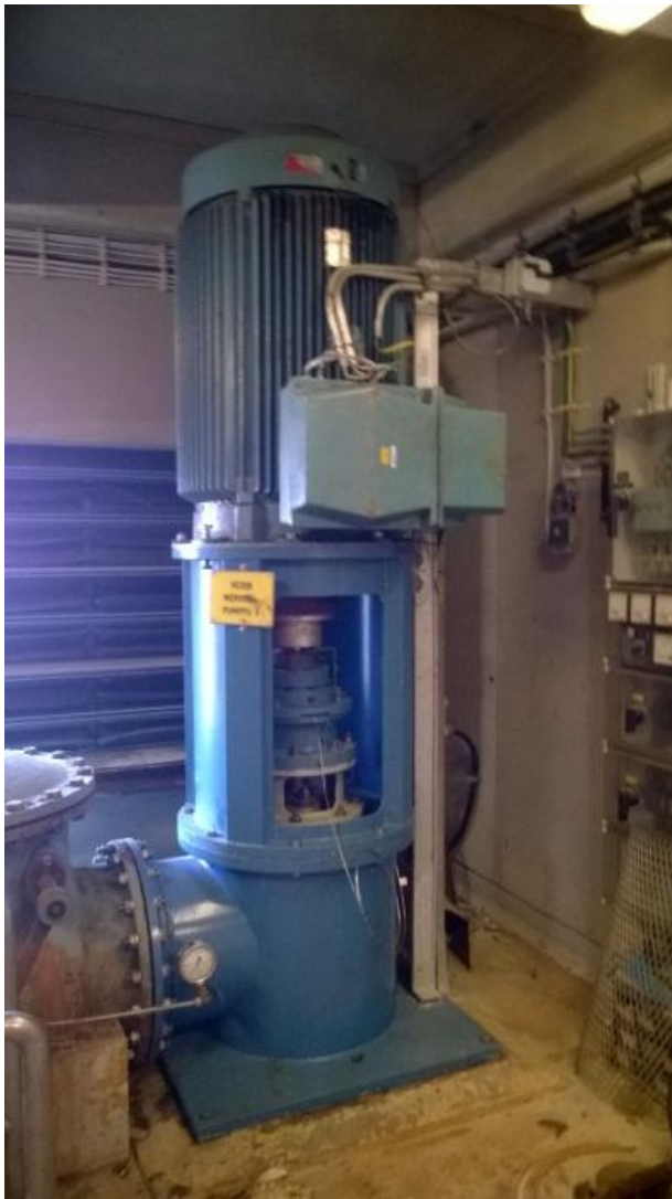
Kuva 6. Pumppu VE308 toiminnassa.
