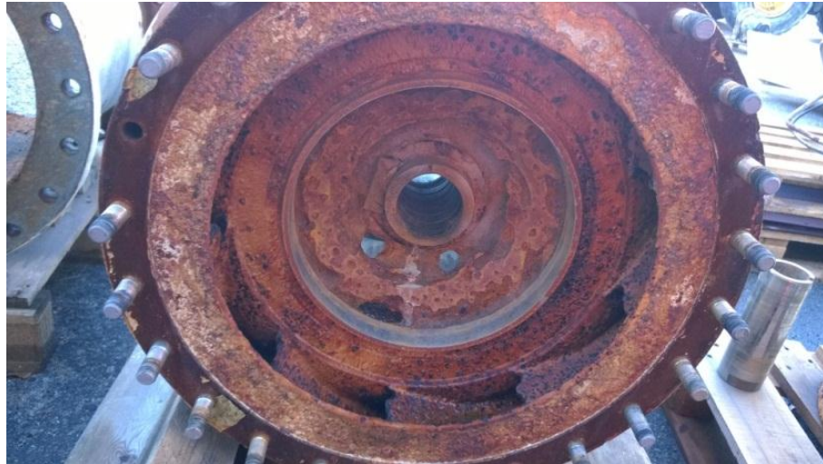
Kuva 13. Pumpun VE307 syöpynyt pesä.
