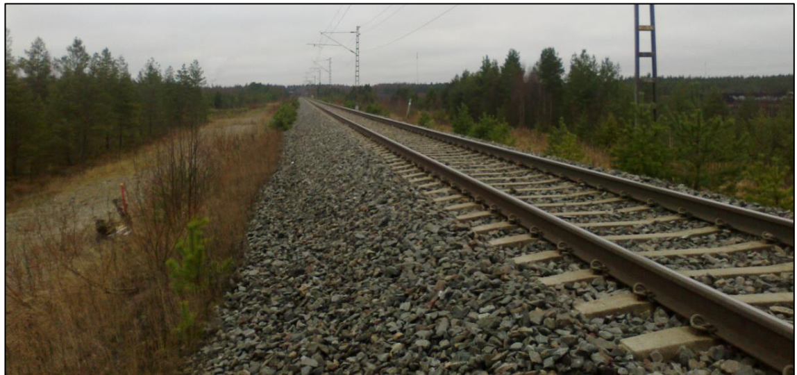
Kuva 5.62. Valokuva radan vierestä (Bäcklund). Vasemmalla näkyy huoltotie ja lähes luonnollisen ympäröivän maanpinnan tasolle painunut vastapenger. Vasemmalla vastapenkereessä voidaan myös havaita kohteen inklinometriputki.
