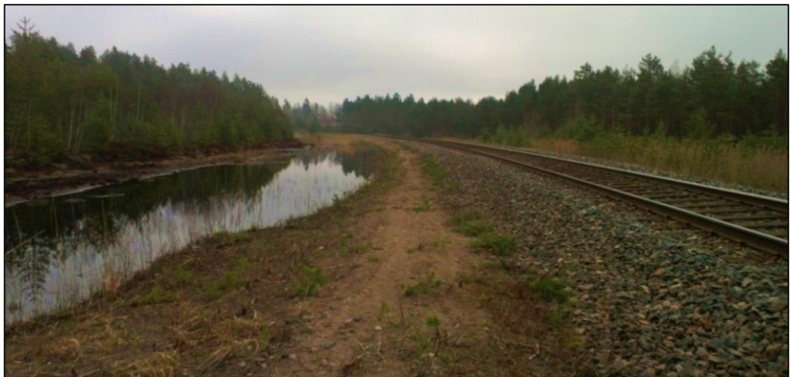
Kuva 5.113. Ylhäällä on havainnollistava poikkileikkaus (Geo-piirustukset) ja alhaalla kuva kohteesta (Bäcklund). Alemmassa kuvassa vastapenkereet ovat selvästi painuneet ympäröivän maanpinnan tasolle.
