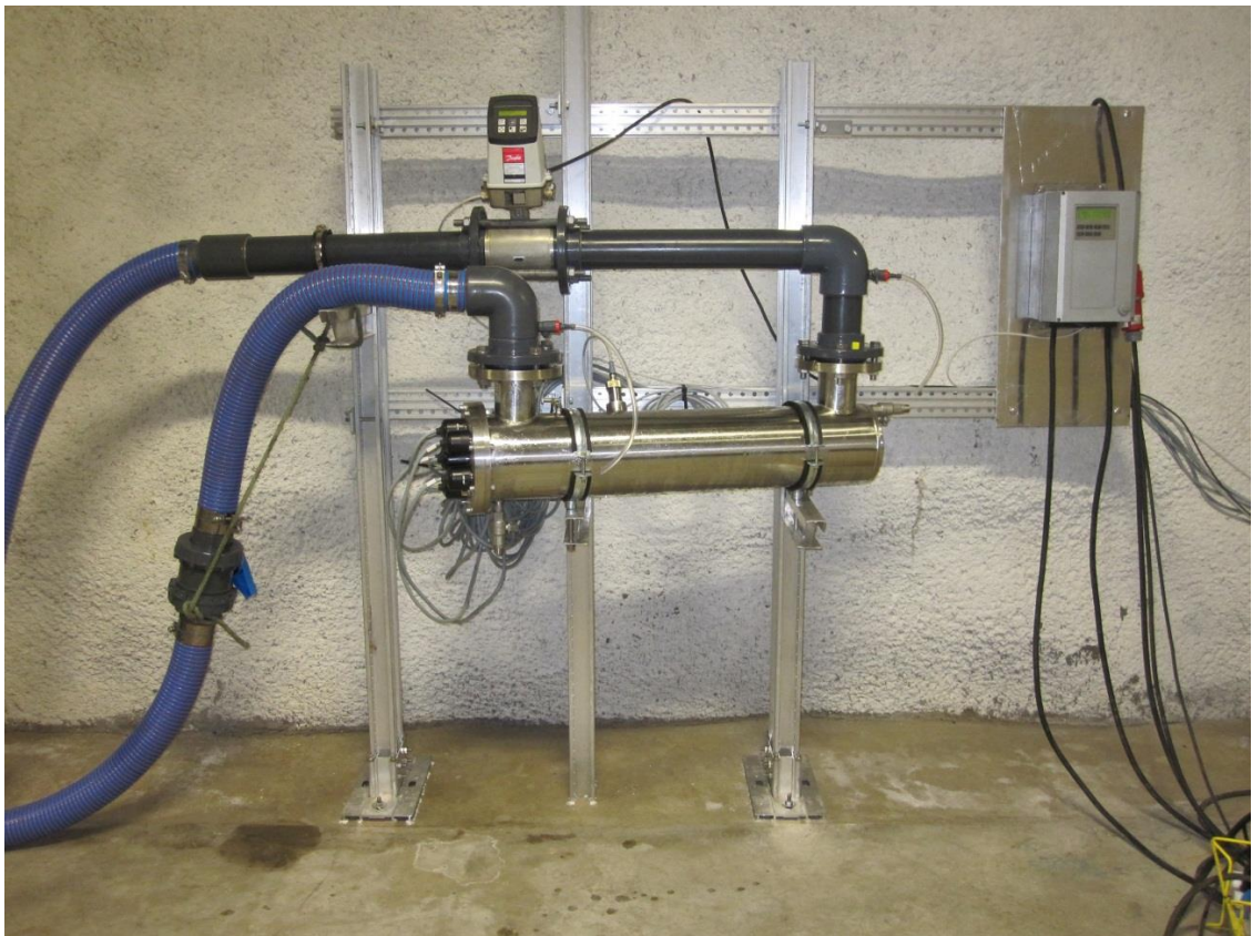
Kuva 12. Kakolanmäen jätevedenpuhdistamolle asennettu UV-koelaitteisto (28.8.2014).
