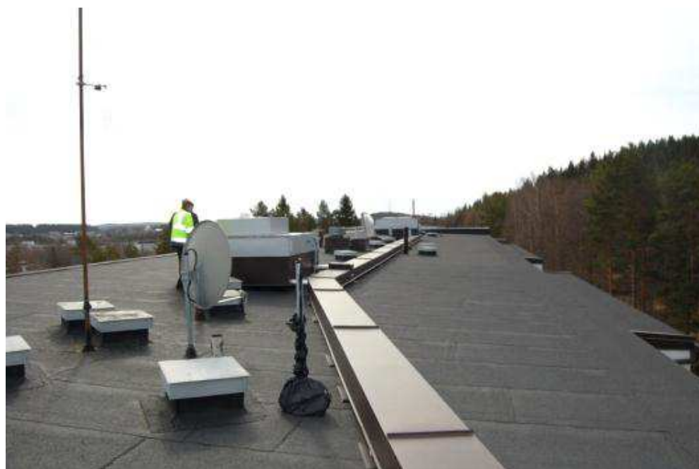
Kuva L7.4: Kylmäaineputket kulkevat katolla poistoilmakanaviin, joihin on asennettu poistoilmapuhallin ja lämmönsiirrin.
