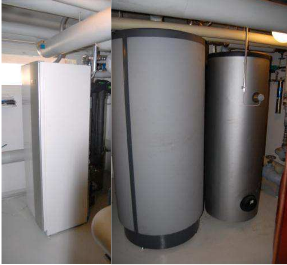
Kuva L7.2: Poistoilmalämpöpumpun kompressorit (vasemmalla) ja lämminvesivaraajat (oikealla) sijaitsevat talon alakerrassa, jossa on myös kaukolämmönvaihdin.
