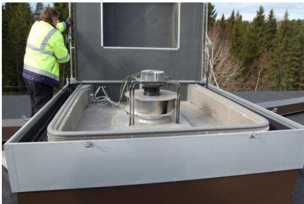
Kuva L7.5: Poistoilmapuhallin ja lämmönsiirtimet.
