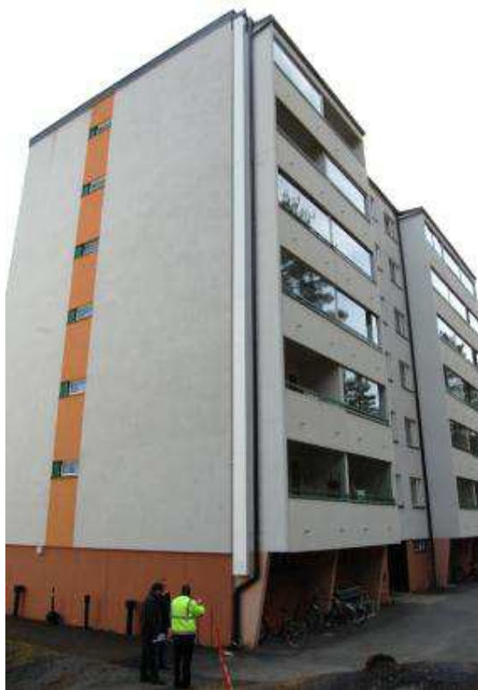
Kuva L7.3: Lämmönjakohuoneesta katolle menevät kylmäaineputket on sijoitettu metallikouruun talon ulkoseinälle.
