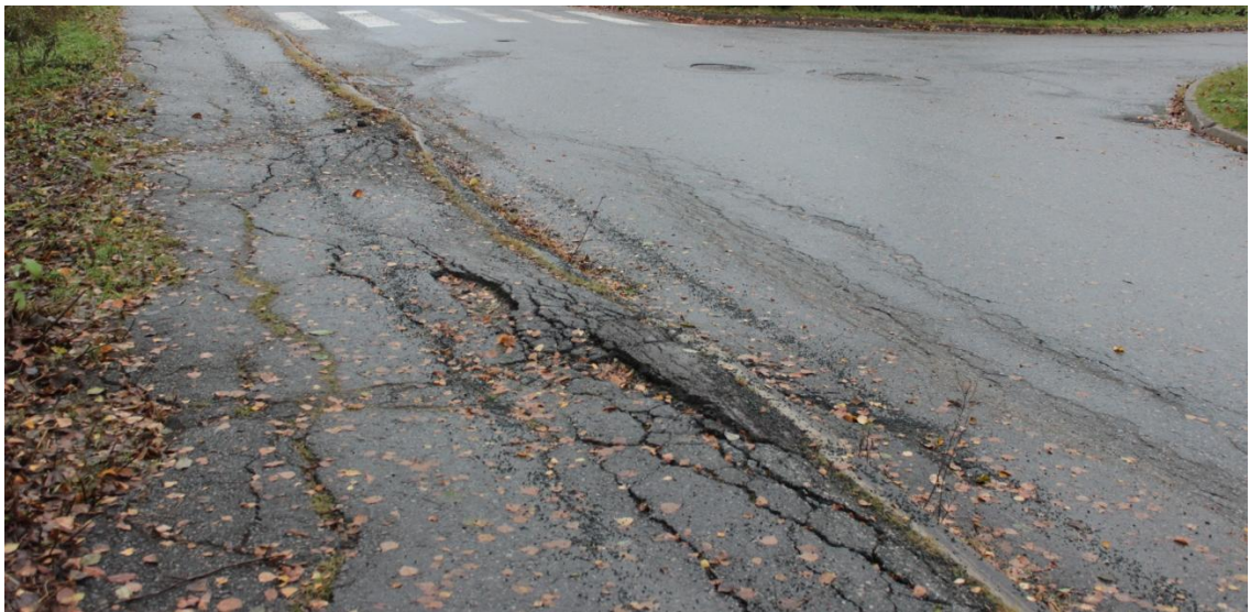
Kuva 32 Routinut jalkakäytävä (kuva: Simo Kesti )
