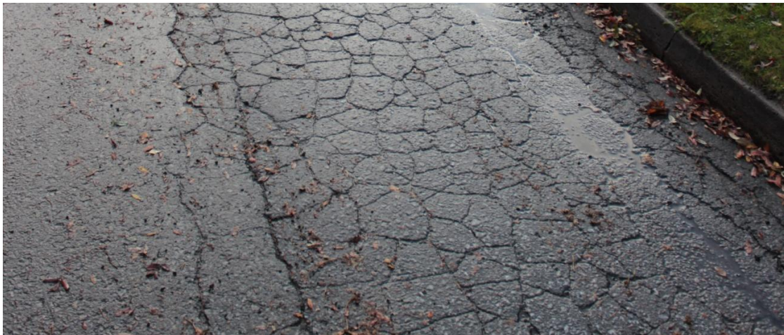
Kuva 36 Verkkohalkeamaa. (kuva: Simo Kesti)
