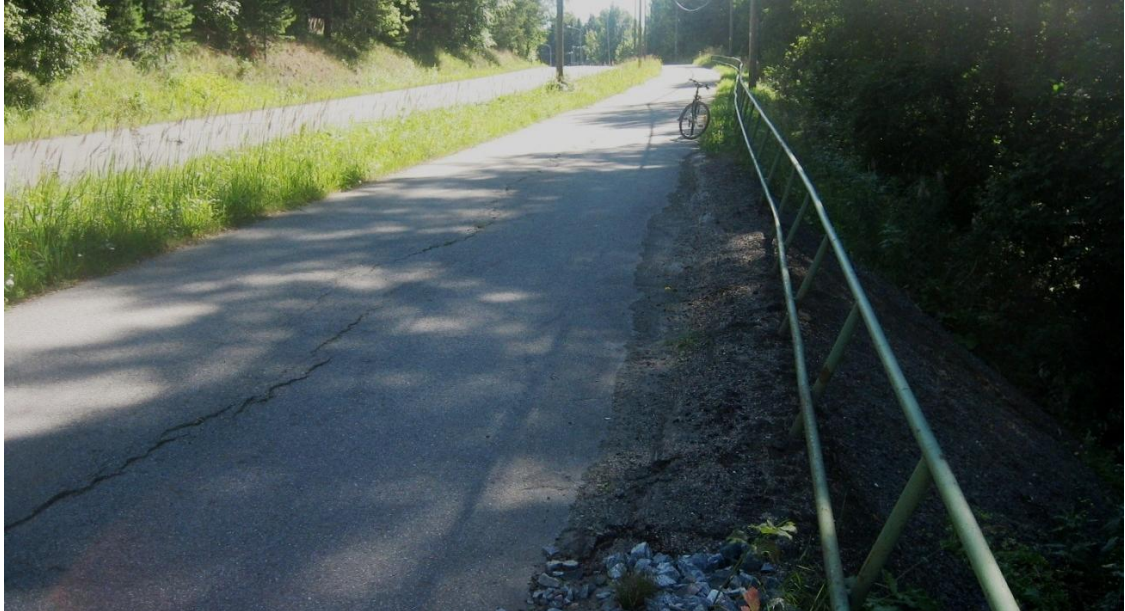
Kuva 35 Luisuvan penkereen aiheuttamia vaurioita. (kuva: Simo Kesti)
