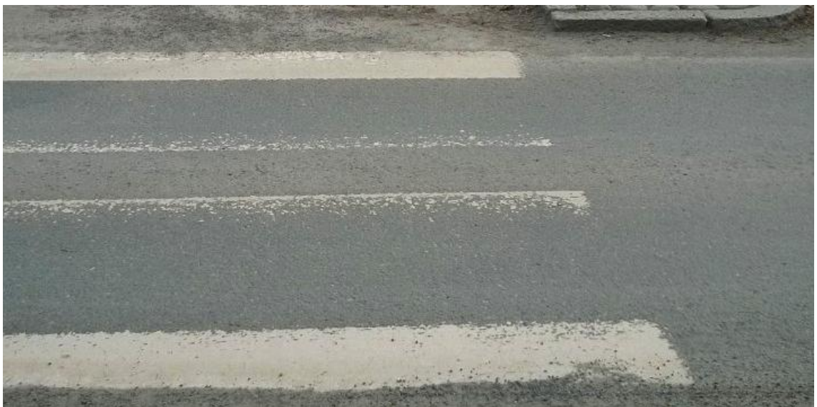
Kuva 37 Osittain kulunut suojatiemerkinä. (kuva: Simo Kesti)
