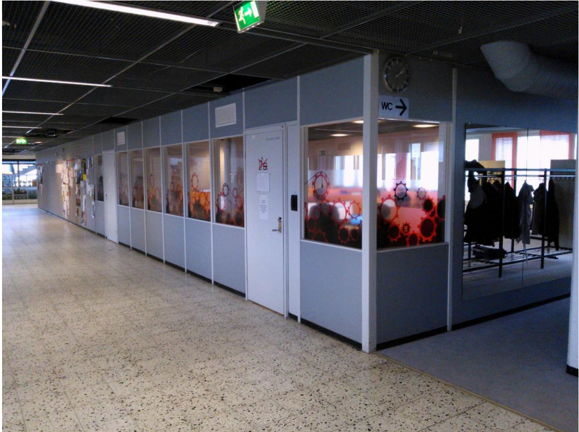
Kuva 4.1. Tutkimuksen kohteena ollut TTY:n Konetalon aulan ATK-luokka K1103. Kaksi luokan siirtoilma-aukkoa näkyy ikkunoiden yläpuolella. Perusajatuksena oli selvittää, voitaisiinko kuormitetun tilan ilmanlaatua parantaa siirtoilman avulla.
