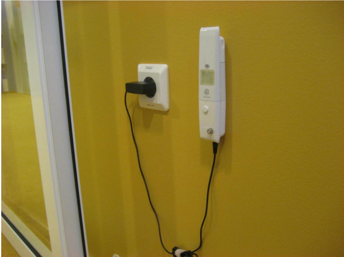
Kuva 4.4. Wirepasin hiilidioksidipitoisuutta mittaava anturi. Hiilidioksidimittaus vaatii korkeamman jännitteen ja anturi on muista antureista poiketen kytkettävä verkkovirtaan. Myös paristokäyttöisiä malleja hiilidioksidipitoisuuden mittaamiseen on nykyään saatavilla.
