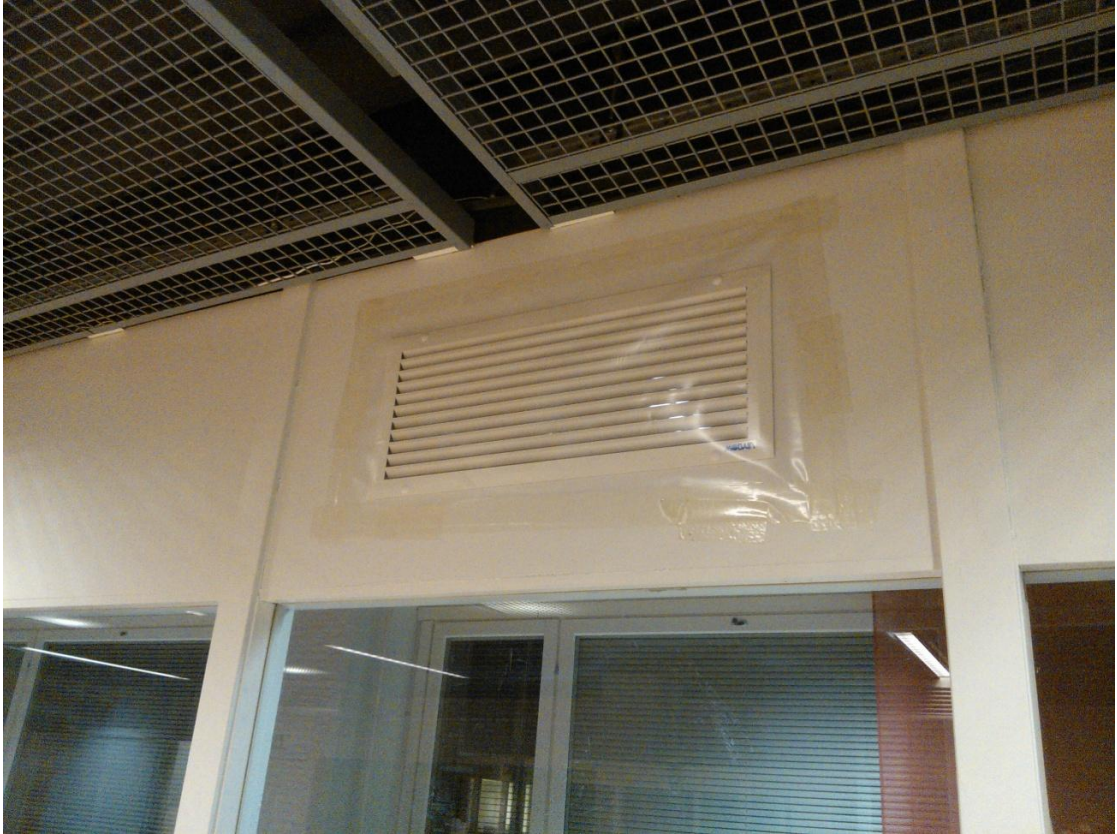
Kuva 4.15. Muovitettu siirtoilma-aukko luokan K1103 seinässä. Kun haluttiin tutkia luokan sisäilman laatua ilman siirtoilman vaikutusta aukkojen asennuksen jälkeen, muovitettiin siirtoilma-aukot mittausten ajaksi.
