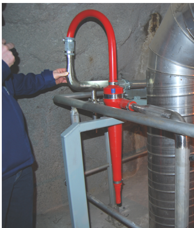
Kuva 26. Prosessialtaan kulmaan asennettu sykloni, jonka erottelukyvyn avulla altaaseen saadaan kaksi eri lieteikää.
