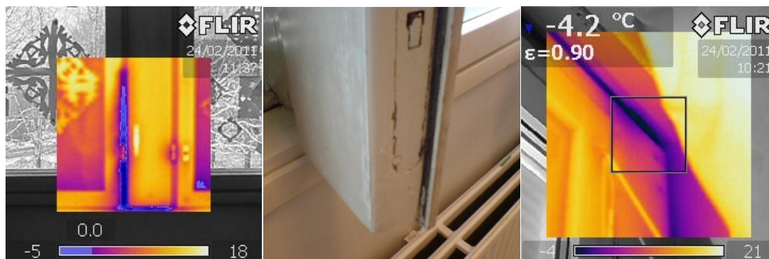
Kuva 7.16. Lämpökamerakuva koulun B erään luokkatilan tuuletusräppänestä ja valokuva tuuletusräppänen tiivisteistä sekä lämpökamerakuva koulun B ikkunan saumojen lämpövuodoista, 24.2.2011. Vasemmanpuoleisessa lämpökamerakuvassa on merkitty vaaleansinisellä ne kohdat, joissa lämpötila on alle 0^{\circ}\text{C} .
