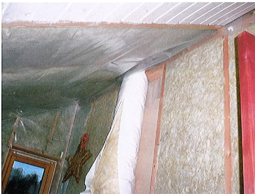
Kuva 26: Alakatto on purettu ja höyrynsulku on näkyvissä. Läpiviintiä ei ole tehty tiiviisti höyrynsulkumuoviin. [53]
