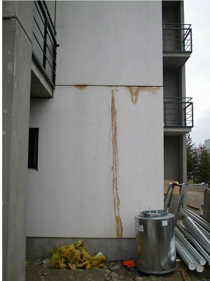
Kuva 5.1. Kosteudesta aiheutunut kosmeettinen haitta valkobetonin pinnalla. Elementin tuuletustilassa kulkenut vesi on poistunut ensimmäisen ja toisen kerroksen välisestä elementtisaumasta värjäten betonin keltaiseksi. (kuva: Hannu Kauranen)
