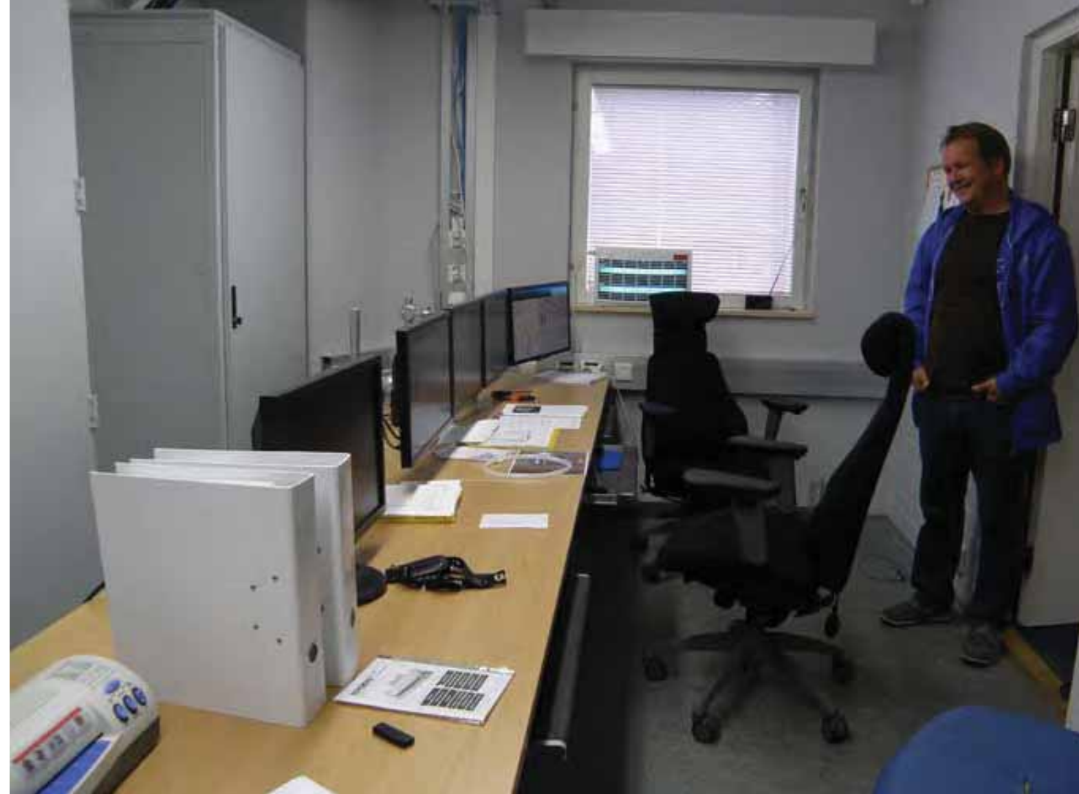
Käyttömestari Jukka Pesu ja jälkikäsittelylaitoksen valvomossa (Juuti & Rajala 2011)
