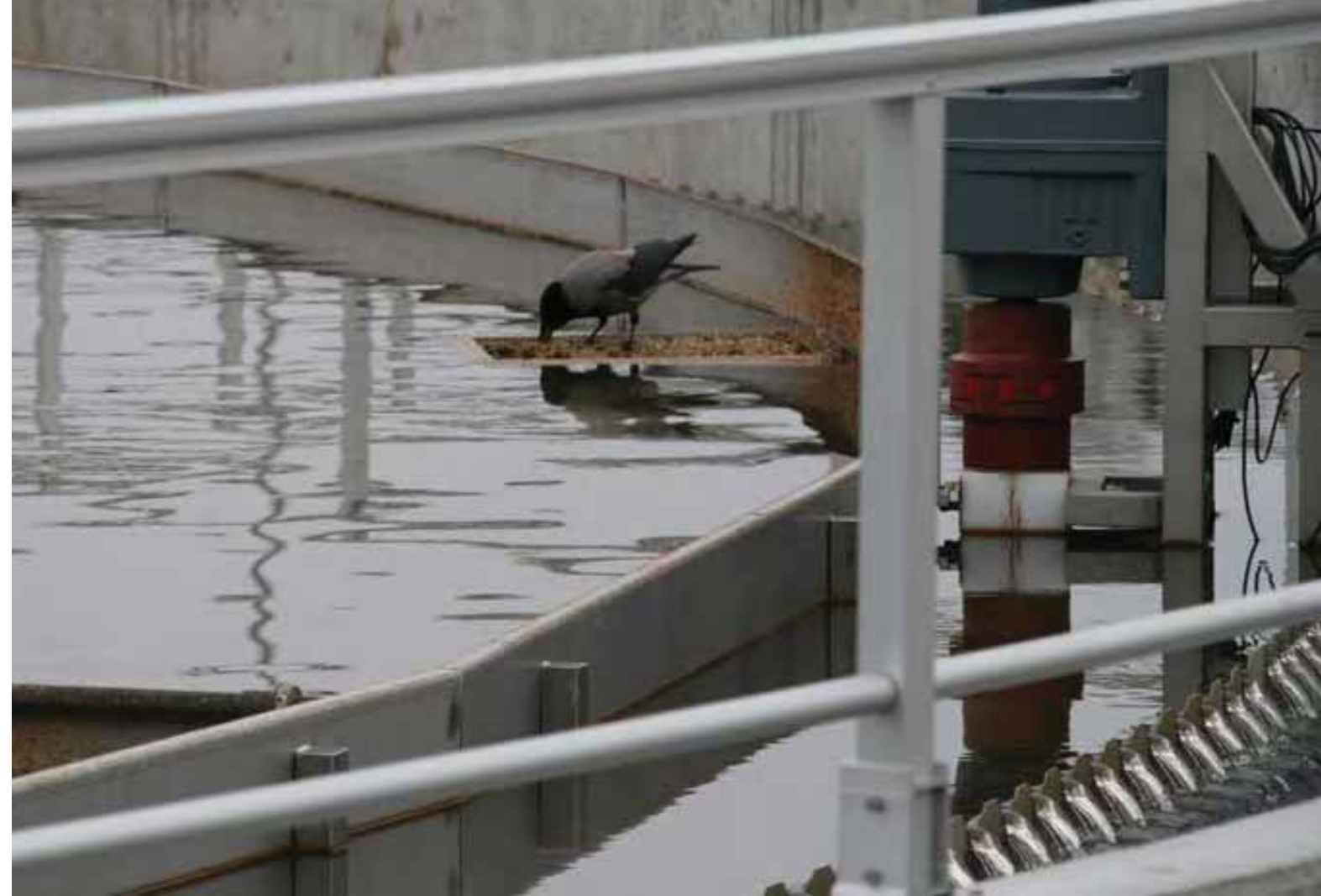
Yläkuvassa Mussalon jälkiselkeytysallas ja alakuvassa ilmastimet.
