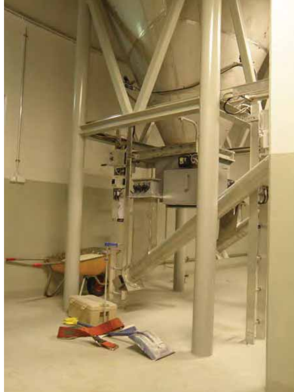
Esikäsitteilylaitoksen kalkin syöttö. (Rajala 2011)
