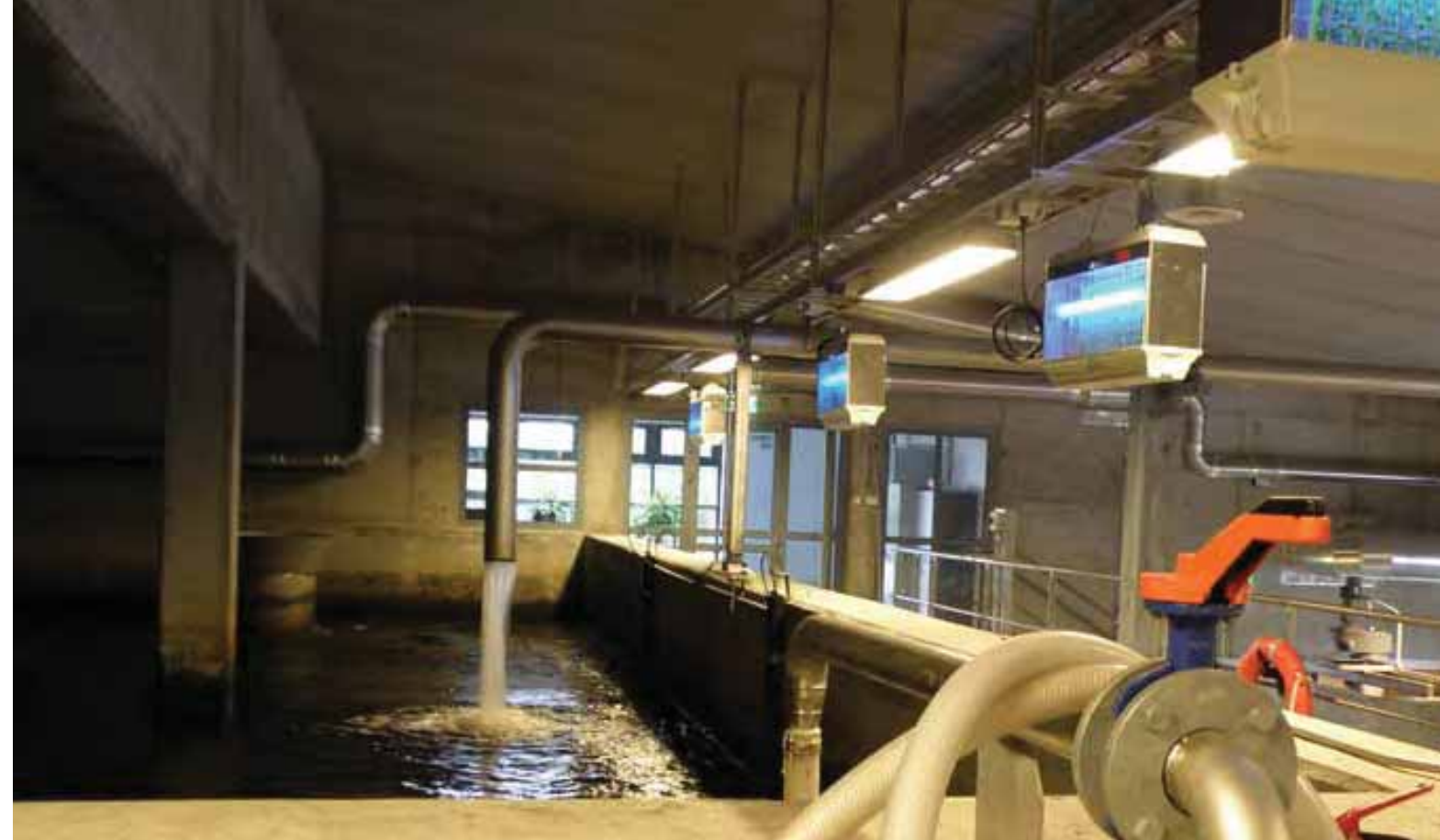
Esikäsitteilylaitoksen tuloallas (Rajala 2011)
