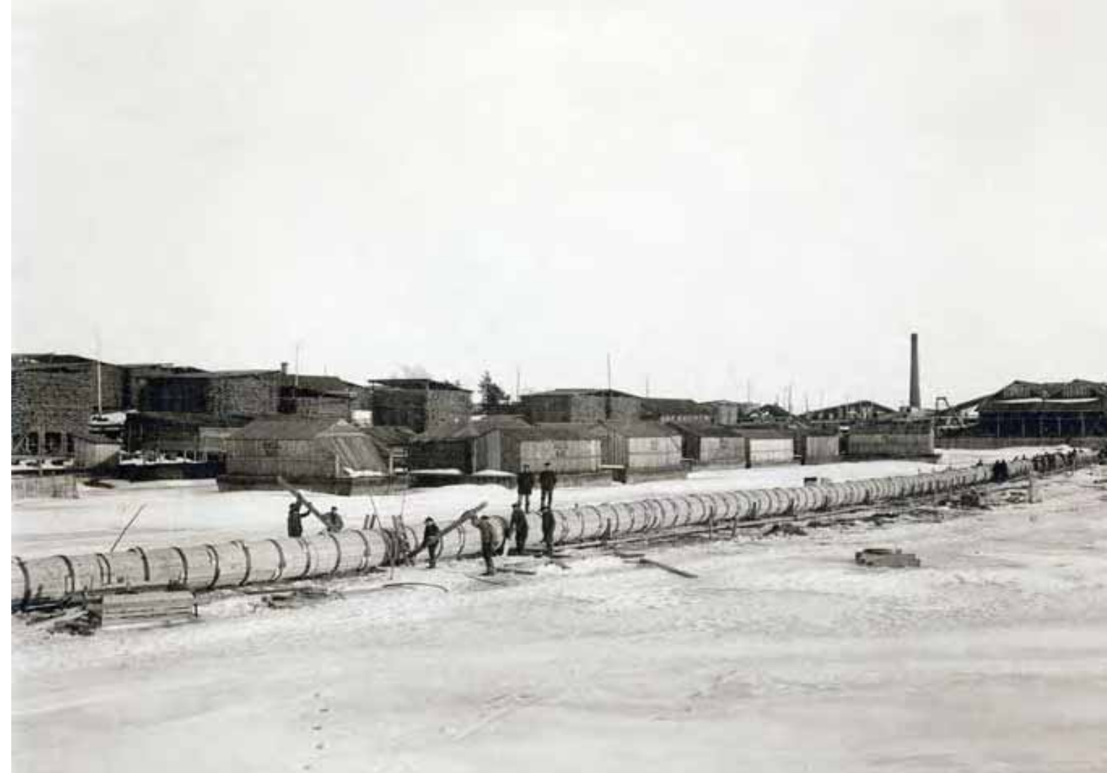
Kotkan sulfaattiselluloosatehtaan vesiputken rakentaminen. Vesiputki Kyminsuuhun (Kymijokeen) rakenteilla. Kuvausaika 1908-1909. (Kymenlaakson museo, Atelier Kotka)
