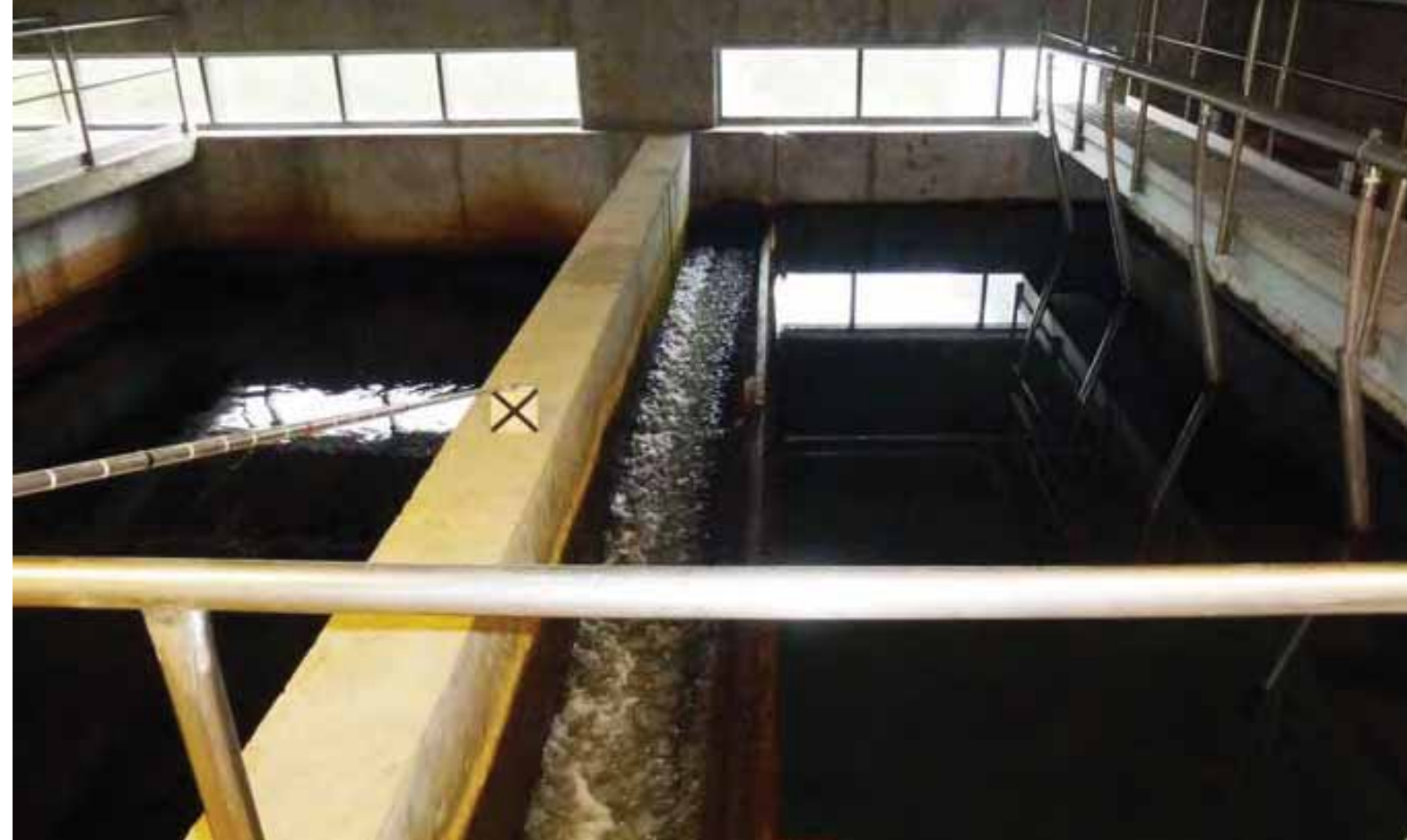
Flotaatio ja hiekkasuodatus esikäsitteilylaitoksessa. (Juuti & Rajala 2011)
