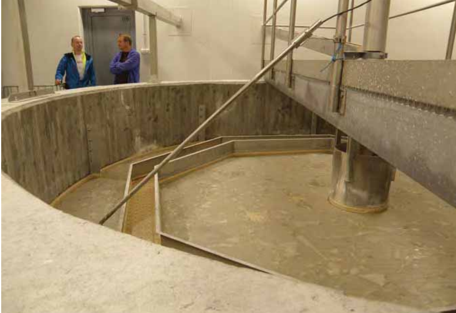
Esikäsitteilylaitoksen kalkkisiilot ns. kalkkimaidon valmistus. Kuvassa dos. Petri Juuti ja käyttömestari Jukka Pesu. (Rajala 2011)
