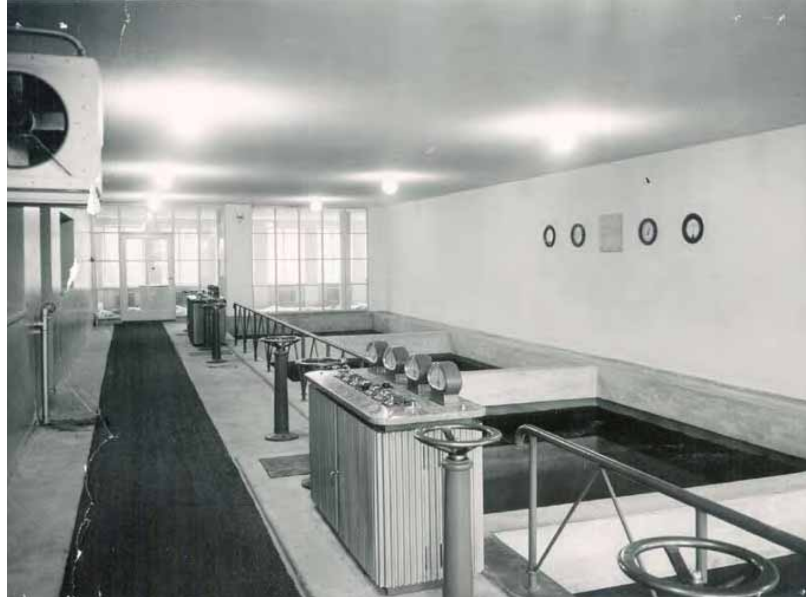
Langinkosken vedenkäsittelylaitoksen vanhanpuolen hiekkasuodattimet ja niiden ohjauspyörät. Kuva vuodelta 1949.
