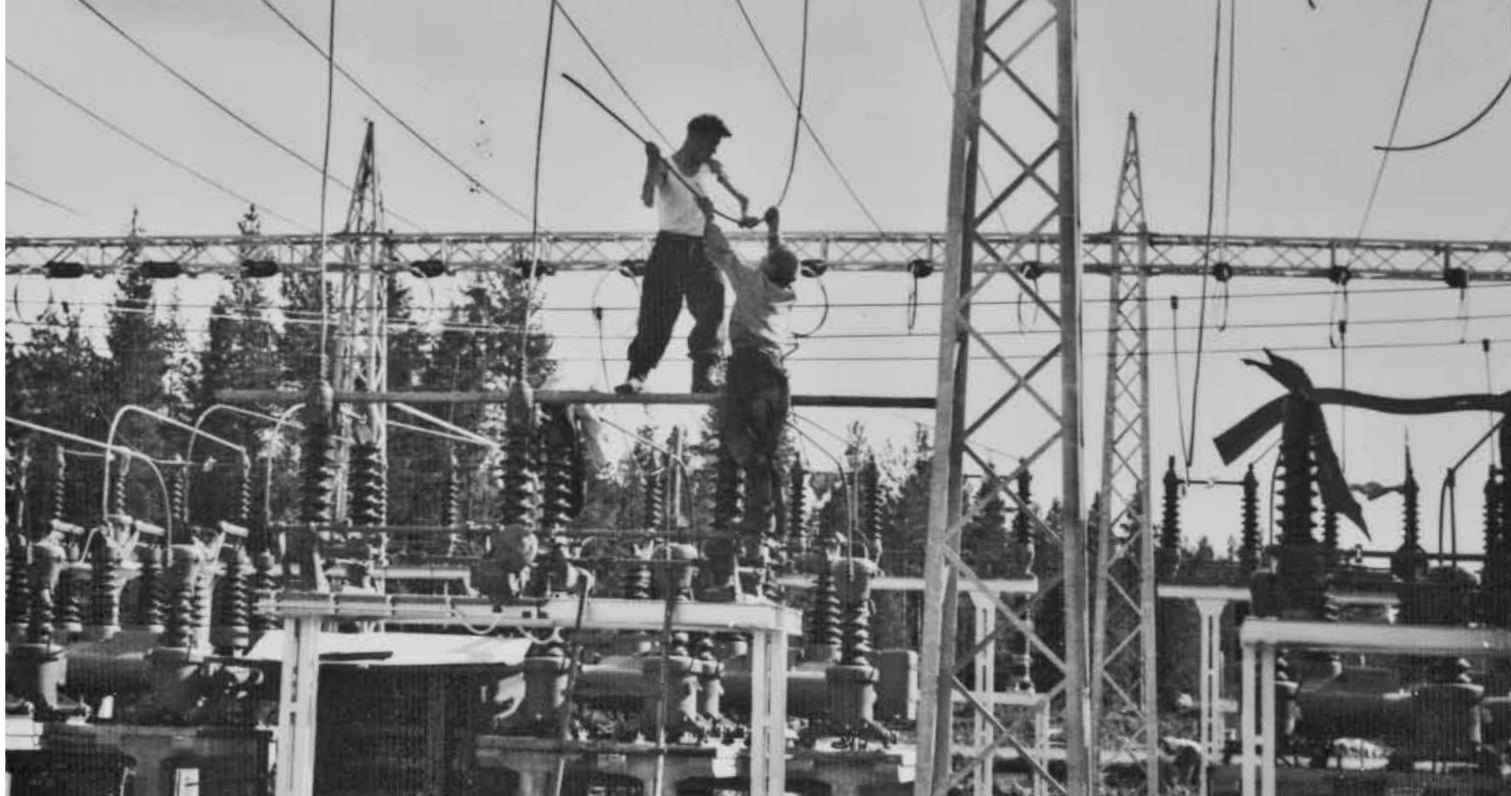
Kiskotusta 45kV:n kytkinlaitoksessa Tuovilassa. 28.9.1954
