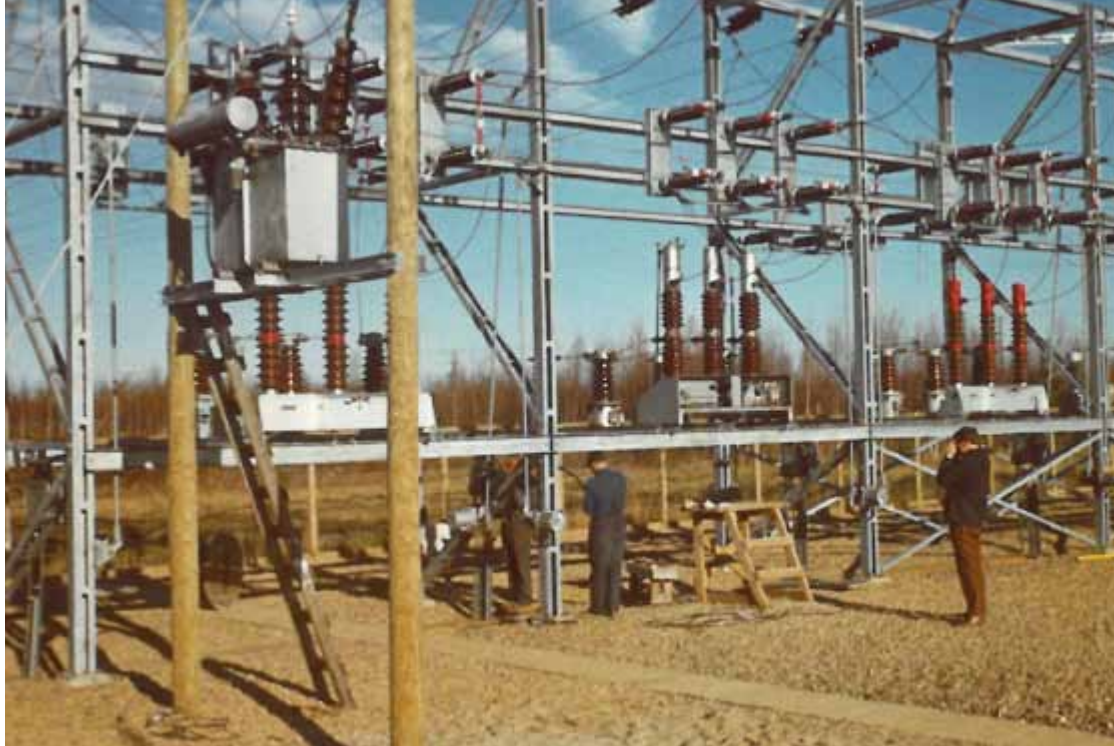
Lapuan sähköaseman 45 kV:n kenttä 1969. Kuvassa asentajat Tapani Välimaa ja Aulis Hakamäki. (Joensuu)
